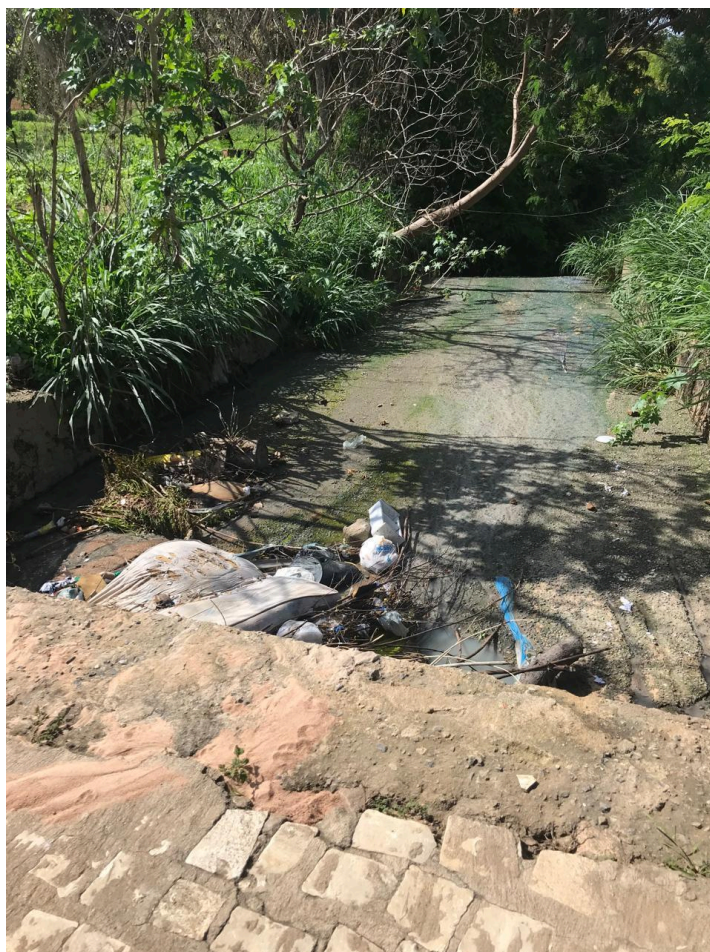
Figura 4 – Bueiro utilizado para o lançamento de esgoto doméstico em Luís Gomes/RN.
