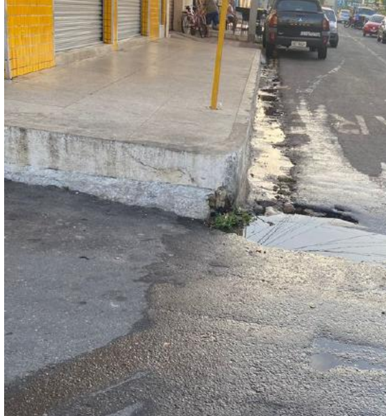
Figura 10: Acúmulo de água usada e poça no entorno do mercado do Alto da Conceição, refletindo falhas no sistema de drenagem e na gestão do espaço público, dados coletados no dia 23/10/2024, às 08h45min da manhã.
