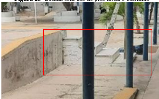
Figura 28- Escada sem uso de piso táteis e corrimão
