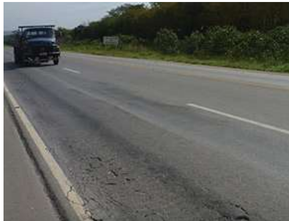
Figura 11: Afundamento de consolidação do Pavimento asfáltico
