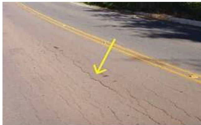
Figura 08: Trinca longitudinal no Pavimento asfáltico
