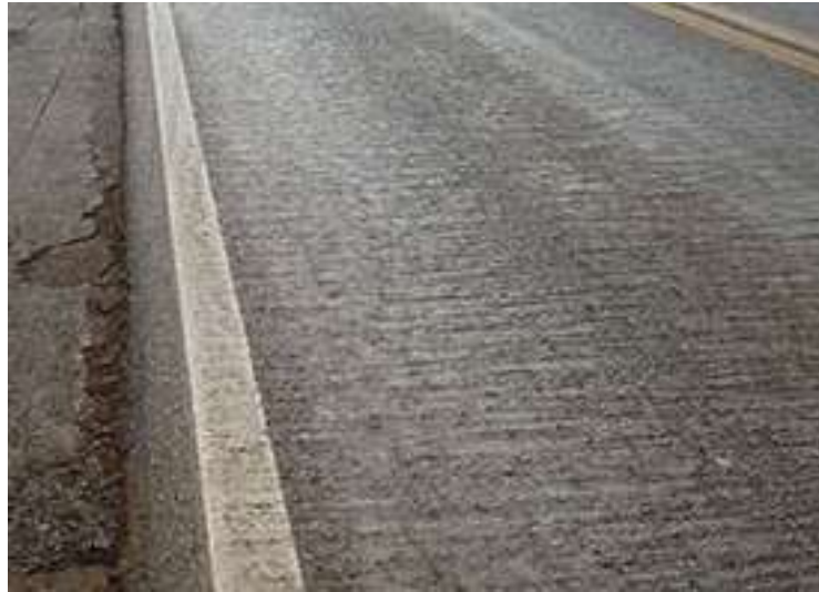
Figura 12: Ondulação ou Corrugação no Pavimento asfáltico
