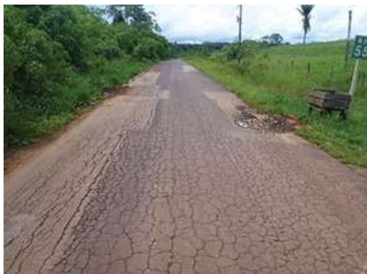
Figura 09: Trincas em malha no Pavimento asfáltico
