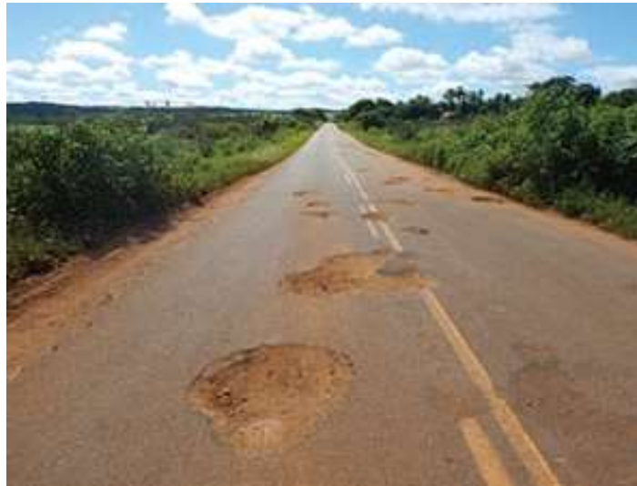
Figura 15: Panela ou buraco no Pavimento asfáltico
