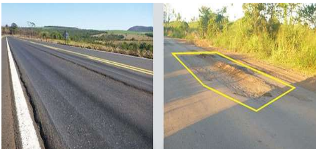
Figura 10: Afundamento plástico do Pavimento asfáltico
