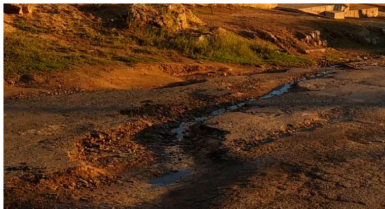
Figura 34: Buraco na rua Antônio Gurjão
