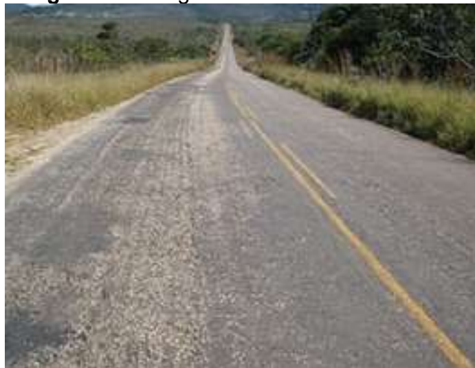
Figura 14: Desgaste do Pavimento asfáltico
