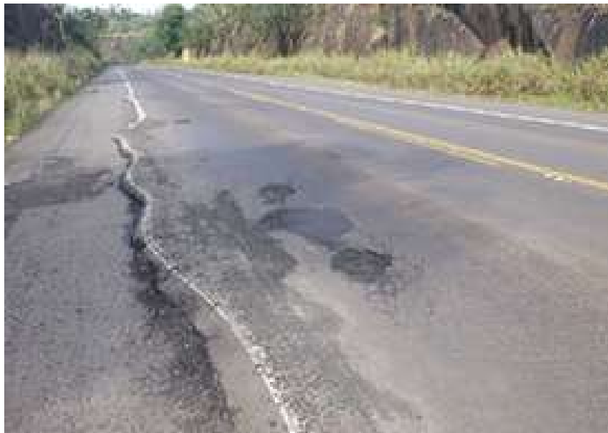
Figura 13: Escorregamento do Pavimento asfáltico
