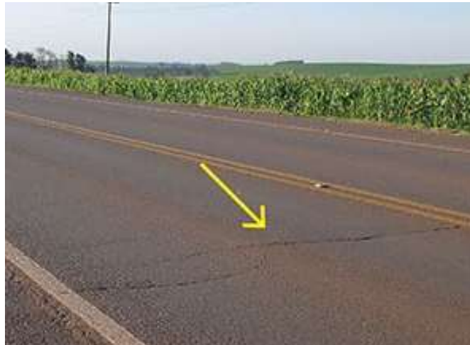
Figura 07: Trinca transversal no Pavimento asfáltico
