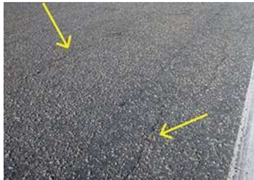
Figura 06: Fissuras no Pavimento asfáltico
