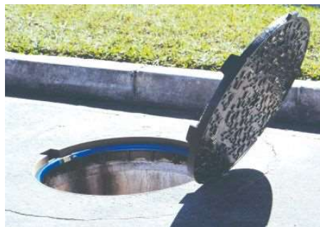
Figura 29: Poços de Visita
