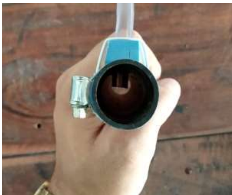
Figura 21: Vista interna da tubulação com a mangueira passando de forma incorreta.
