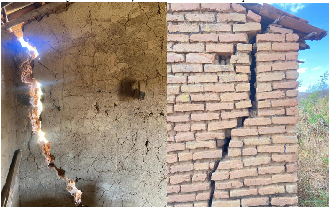
Figura 86 – Edificação com alvenaria em estado precário.
