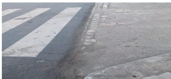
Figura 3. Desnível entre rebaixamento da calçada e a via de circulação de veículos. (Autoria própria)
