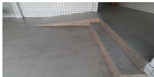
Figura 6. Rampa e degraus que representam desníveis sem proteção contra queda. (Autoria própria)
