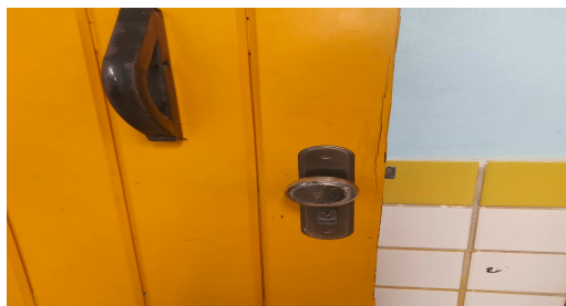
Figura 8. Puxador vertical instalado inadequadamente e maçaneta circular. (Autoria própria)
