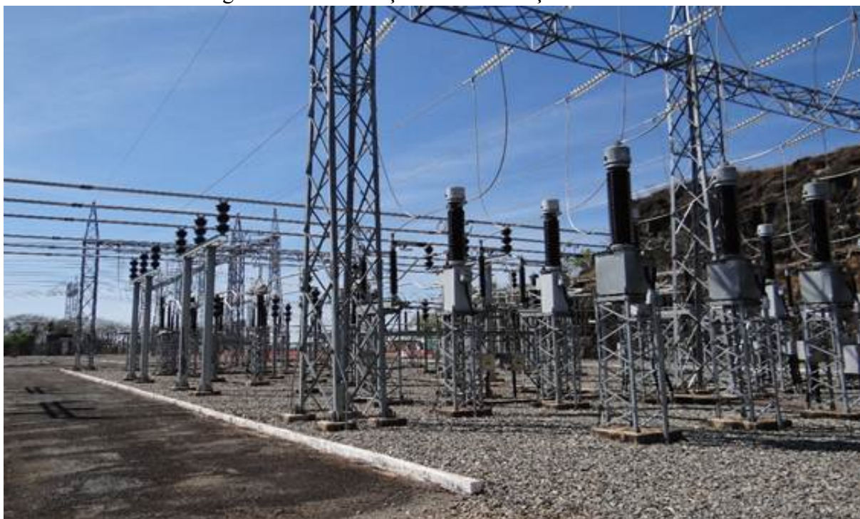
Figura 01 - Subestação de Emborcação de 500kV
