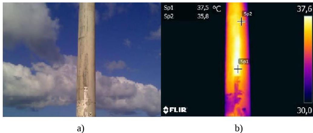
Figura 26 - Poste a) com corrosão de armaduras; b) termograma indicando a presença de corrosão pela diferença de temperaturas.
