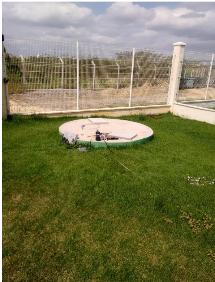
Figura 11 - Tanque de armazenamento
