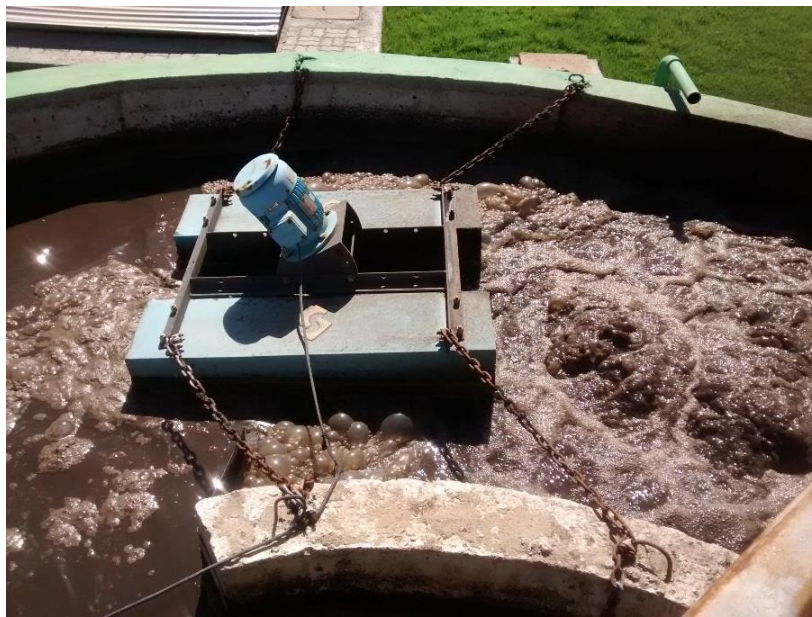
Figura 9 - Aerador em funcionamento
