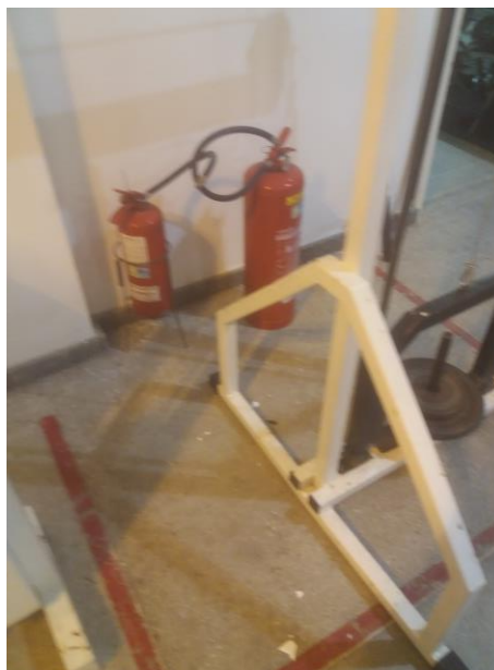
Figura 10 - Extintores de incêndio da garagem
