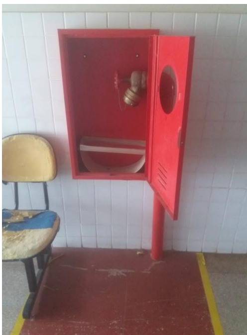
Figura 11 - Hidrante do laboratório de engenharia de energia e mecânica
