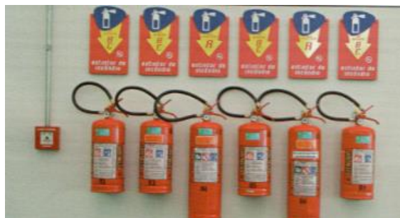
Figura 7 - Extintores de incêndio
