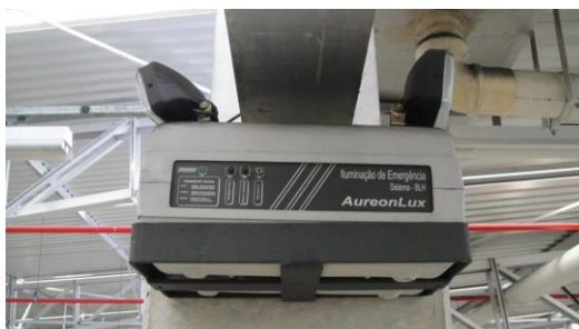
Figura 6 - Bloco autônomo do sistema de iluminação de emergência
