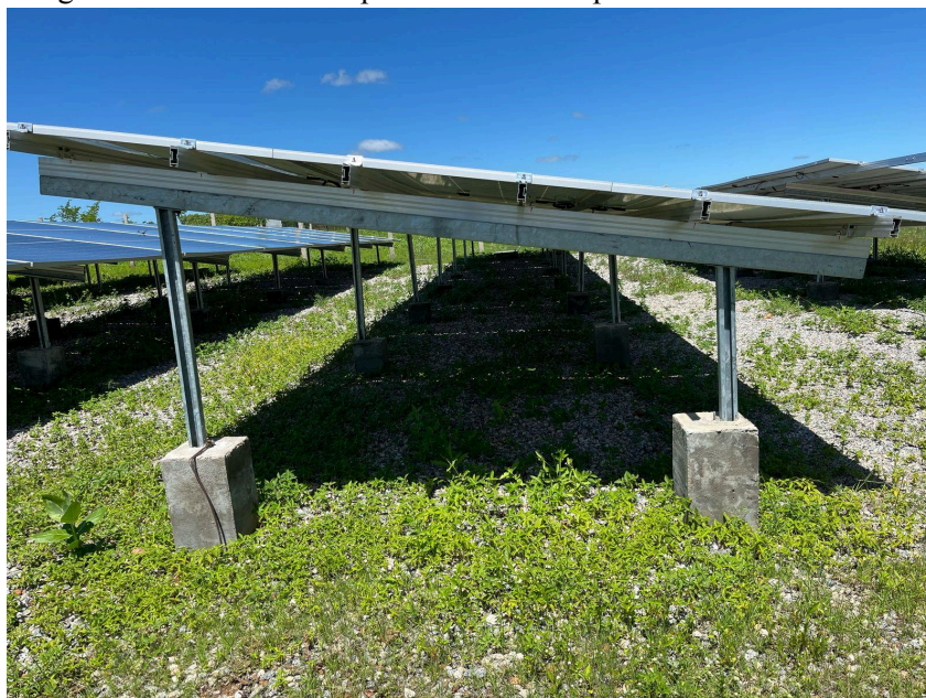
Figura 5 - Estrutura de suporte metálico de painéis fotovoltaicos.
