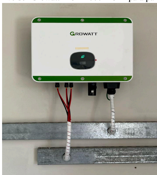
Figura 4 - Inversor Growatt MOD 4000TL3-X para painéis solares.
