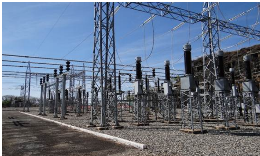
Figura 7 - Subestação de Energia.
