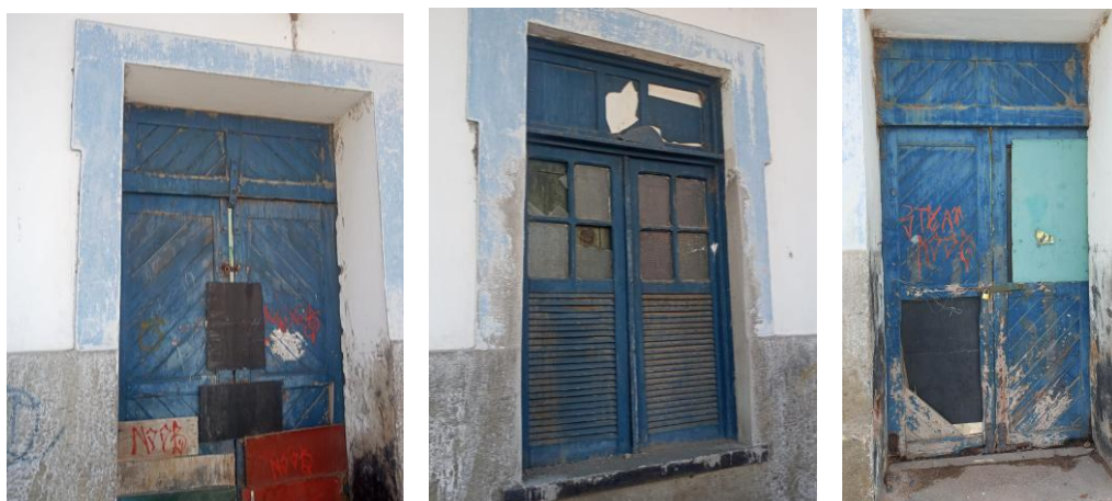
Figura 52 - Realidade atual as esquadrias de madeira da estação ferroviária
