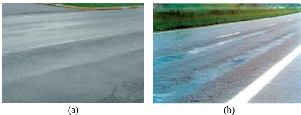
Figura 4: (a) Afundamento plástico da trilha de roda; (b) Afundamento de consolidação da trilha de roda
