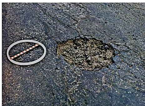
Figura 9: Panela ou buraco
