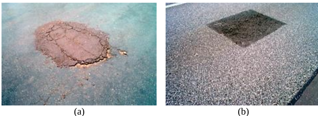
Figura 10: (a) Remendo mal executado; (b) Remendo executado corretamente
