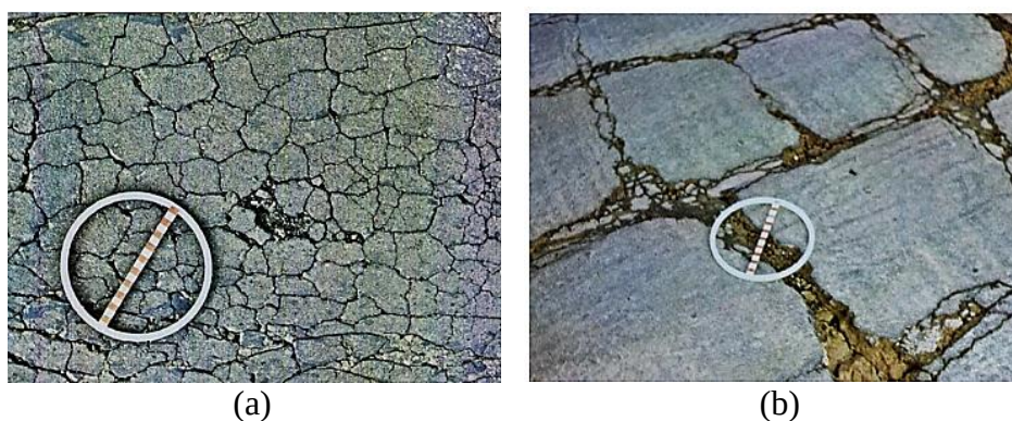
Figura 3: (a) Trinca “couro de jacaré”; (b) Trinca “bloco”
