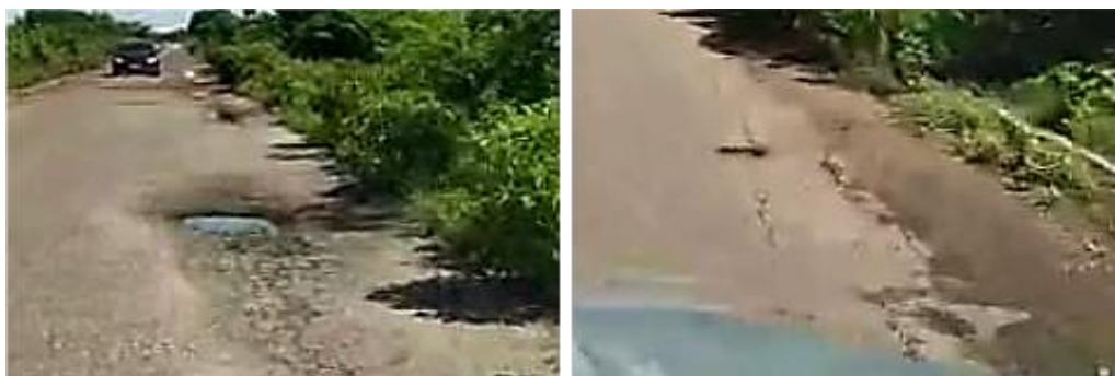
Figura 20: (a) Trincas isoladas; (b) “ Couro de jacaré ”
