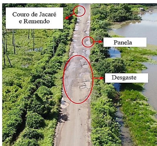
Figura 23: Indicação de defeitos no trecho
