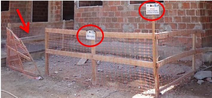
Figura 28 – Isolamento e sinalização de área de risco na obra analisada
