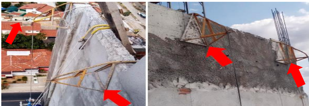
Figura 8 – Afastadores metálicos ancorados a uma estrutura
