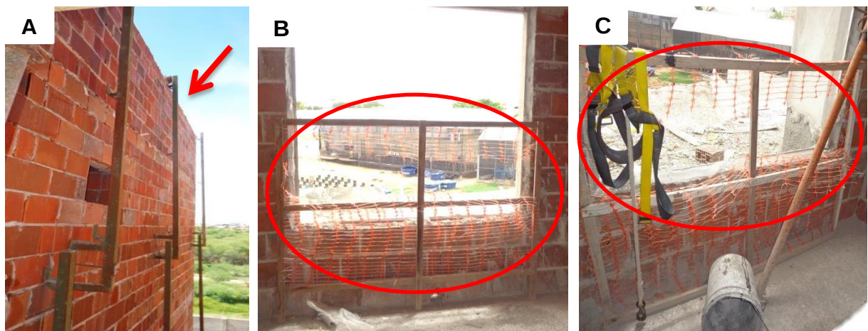
Figura 29 – Elementos de proteção coletiva das periferias da obra analisada
