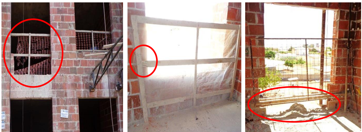
Figura 21 – Proteção periférica encontrada na obra analisada
