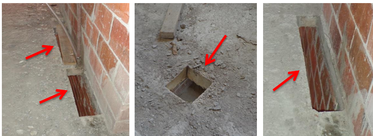
Figura 18 – Aberturas no piso encontradas na obra analisada
