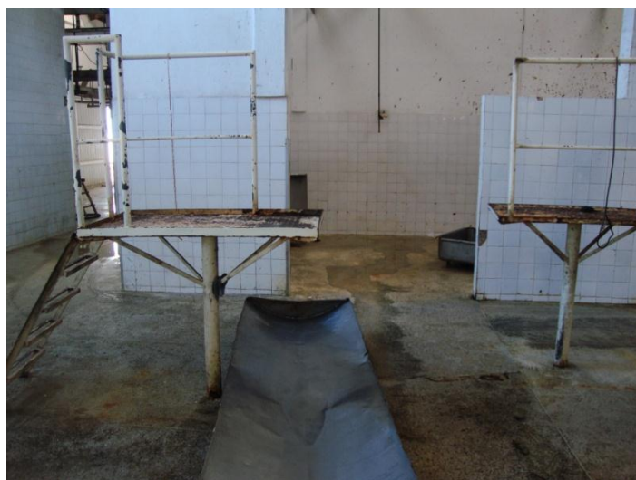
Figura 06: Abatedouro B. Equipamentos e instalações sem manutenção.
