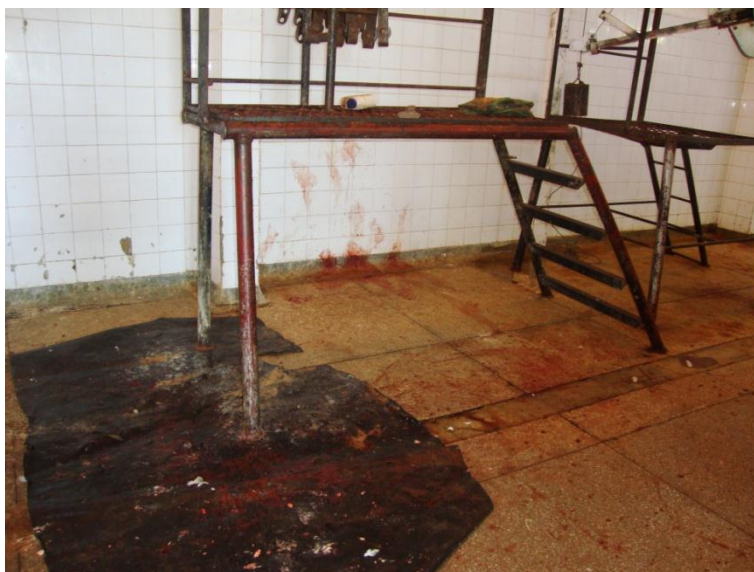
Figura 10: Abatedouro D. Condições estruturais e higiênicas precárias.
