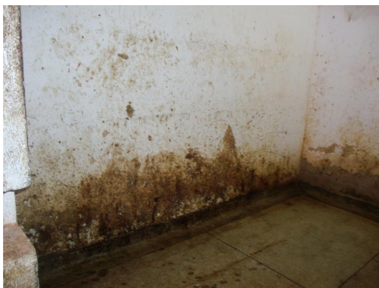
Figura 11: Abatedouro D. Condições higiênicas precárias em piso e parede.
