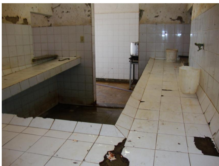
Figura 14: Abatedouro D. Condições inadequadas de paredes e bancadas.
