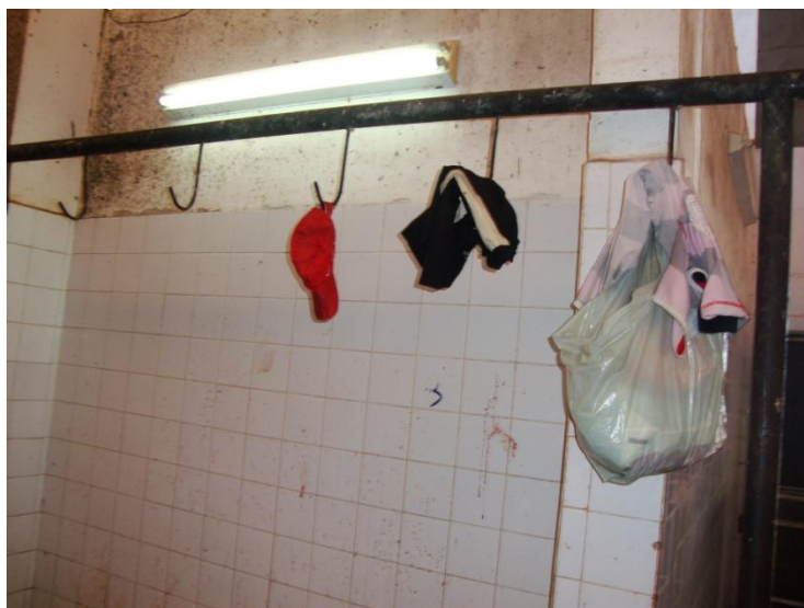
Figura 13: Abatedouro D. Acondicionamento inadequado de materiais na sala de abate.
