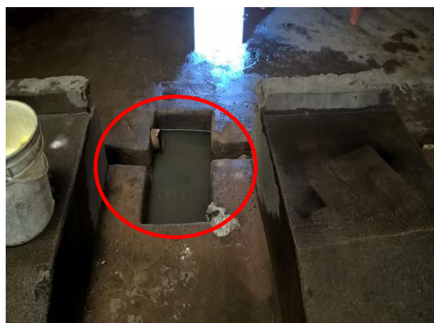
Figura 10 – Despejos de efluentes líquidos dos lavajatos de Pau dos Ferros, 2016.
