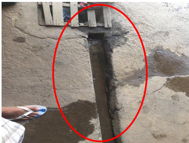
Figura 14 – Rede de esgotos de lavajatos do município de Pau dos Ferros, RN.
