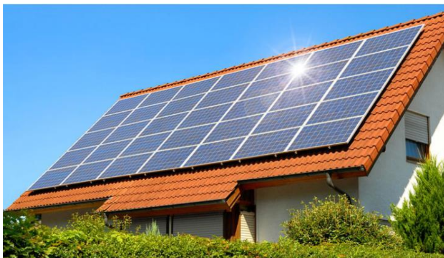
Figura 2. Módulos fotovoltaicos instalados.
