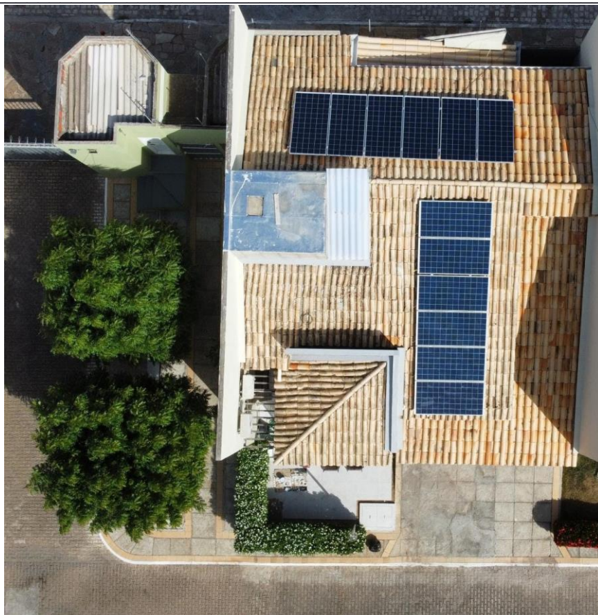
Figura 6. Lote 1 no Condomínio Luzia Rodrigues, na residência em que a incidência solar é favorável para a instalação do sistema fotovoltaico. Fonte: Solar Energy.
