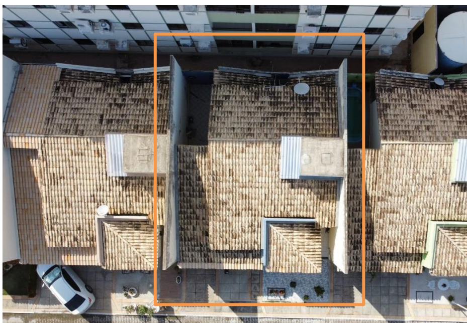
Figura 7. Lote 2 no Condomínio Luzia Rodrigues, onde é perceptível o efeito do sombreamento que interfere na total eficiência da instalação do sistema foto voltaico. Fonte: Solar Energy.
