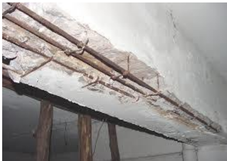
Figura 04 -Viga com patologias que deverá ser reforçada.
