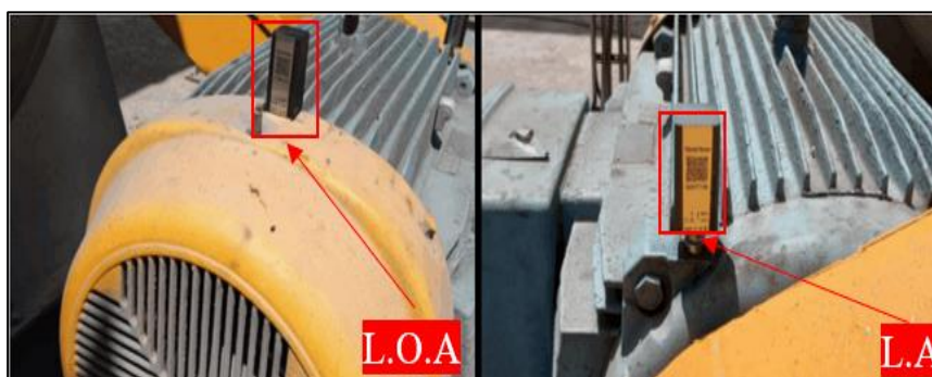
Figura 18 – Sensores posicionados em um Motor elétrico no lado oposto ao acoplado (L.O.A) e lado acoplado (L.A)
