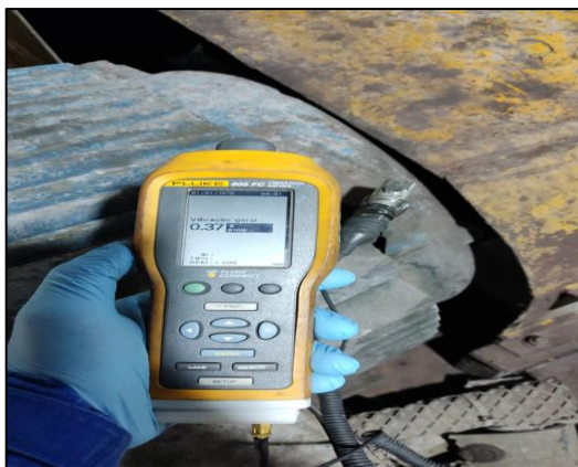
Figura 02 – Acelerômetro conectado ao aquisitor de dados para captação de vibração
