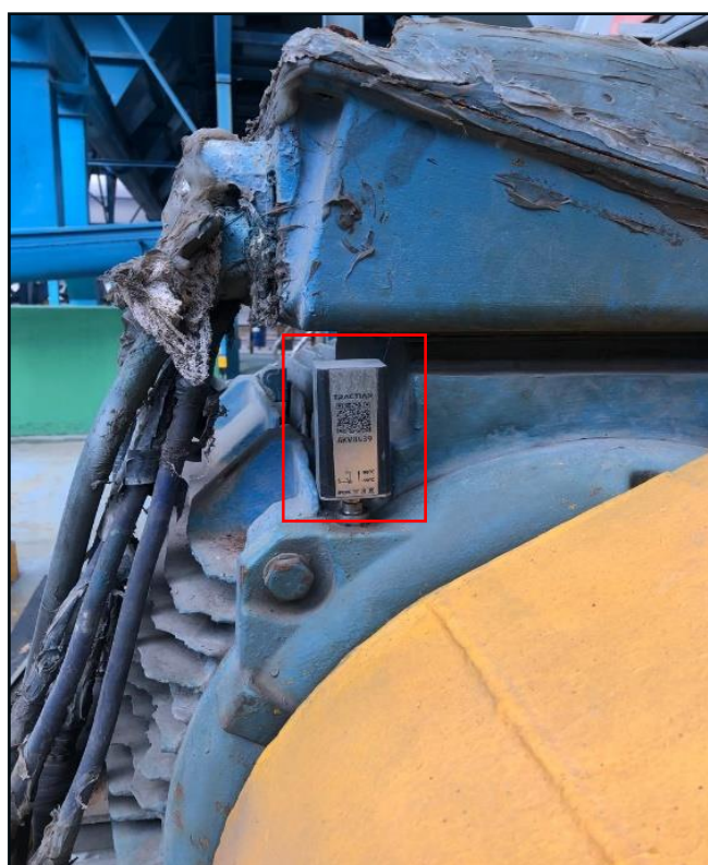
Figura 07 – Sensor IoT em um Motor Elétrico
