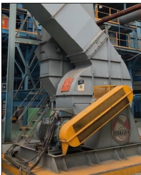
Figura 14 – Exaustor centrífugo de um filtro de mangas
