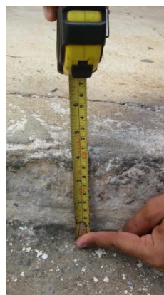
Figura 11- Desnível rua - calçada
