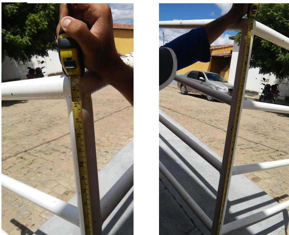
Figura 18- Altura do Corrimão de acesso às secretarias
