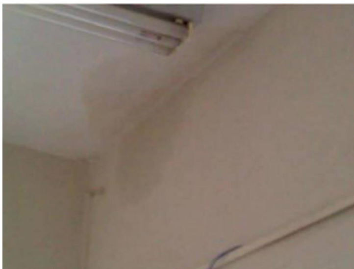
Figura 1 – Infiltração na parede e teto
