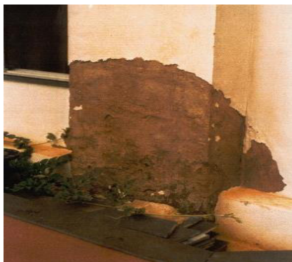
Figura 4 – Desagregação da argamassa
