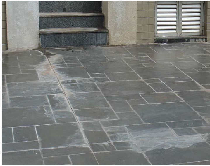
Figura 3 – Eflorescência em piso
