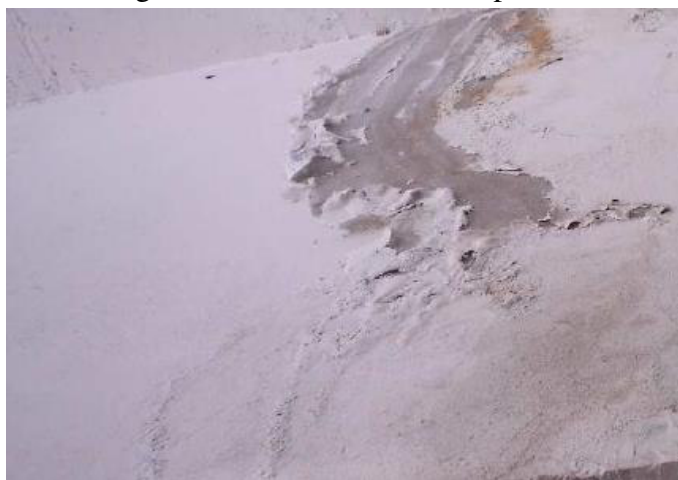
Figura 5 – Descascamento de pintura
