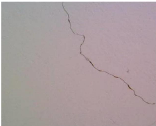
Figura 8 – Fissura na parede
