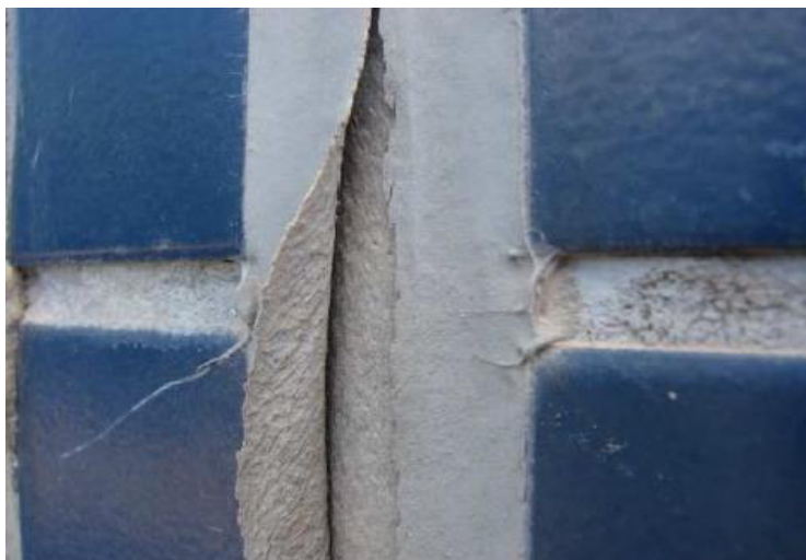
Figura 7 – Camada de preenchimento excessivamente fina
