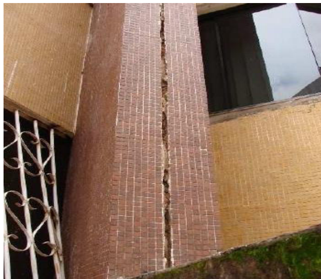
Figura 6 – Falha na junta estrutural
