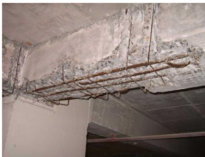
Figura 5- Corrosão em armadura de concreto. FONTE: Instituto Brasileiro de Desenvolvimento da Arquitetura.
