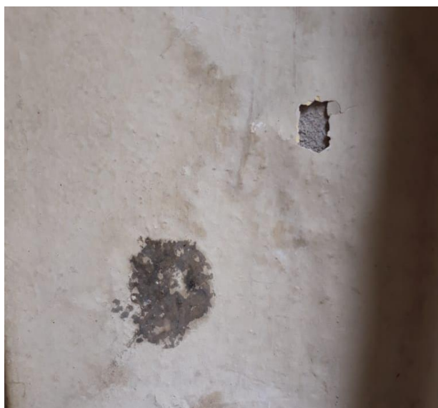
Figura 9- Bolor e deslocamento. FONTE: Autoria própria (2019)
