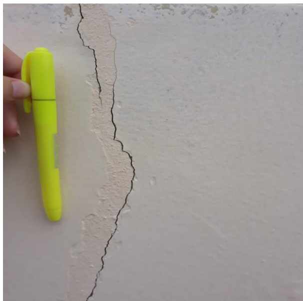
Figura 10- Trincas e rachaduras.FONTE: Autoria própria (2019)
