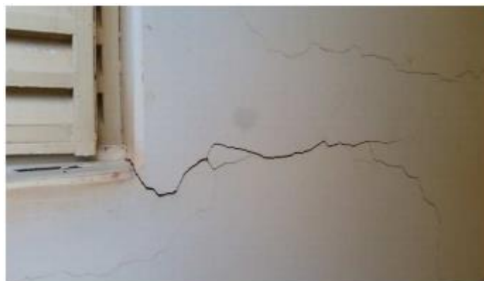
Figura 3- Fissuras no canto inferior da janela. FONTE: ZANZARINI (2016)
