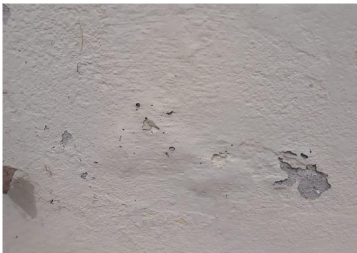
Figura 8 – Eflorescência. FONTE: Autoria própria (2019)
