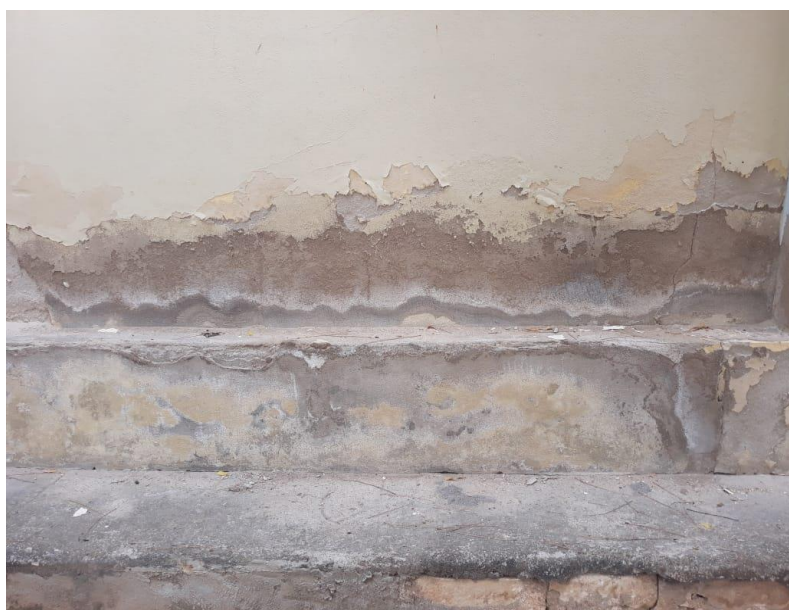
Figura 11- Eflorescência e deslocamento.FONTE: Autoria própria (2019)
