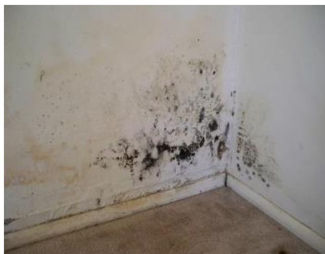
Figura 2- Bolores em paredes. FONTE: Eugene K. Chatman (2019)
