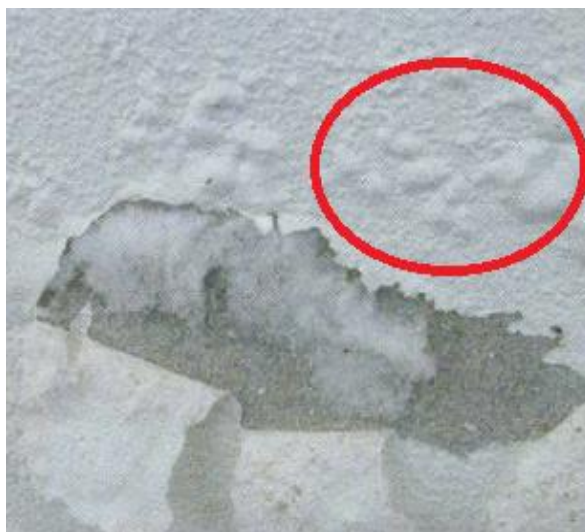
Figura 4- Eflorescência. FONTE: Adaptado da Revista de Patologia de Tocantins (2009).
