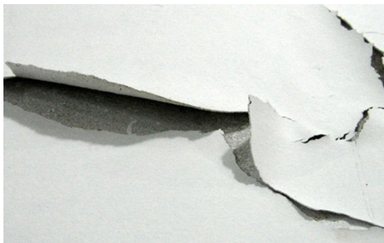
Figura 2- Descascamento de pintura
