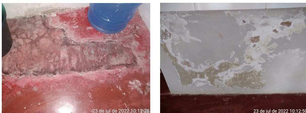
Figura 17 - Infiltração Causada por Problemas na Instalação Hidráulica
