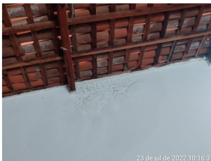
Figura 13- Manchas de infiltração em peças de madeira
