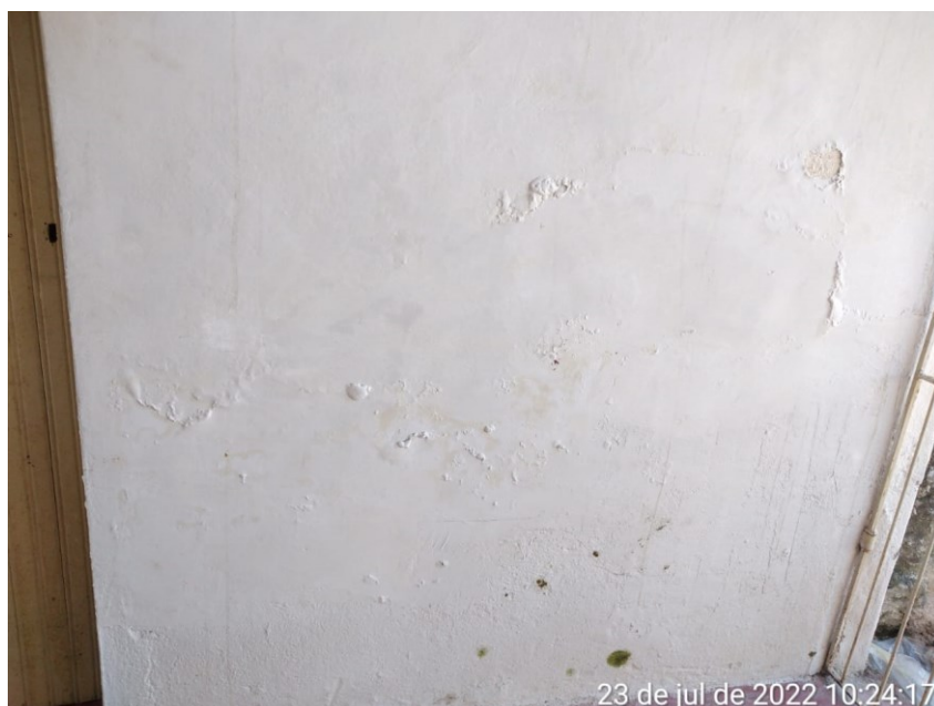
Figura 18 - Bolor causados por Problemas de Umidade
