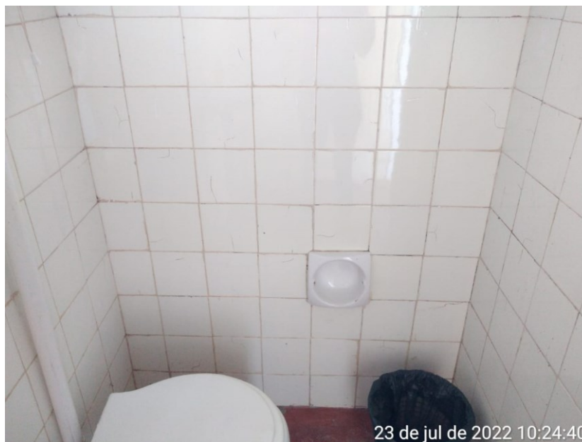
Figura 19 - Fissuras no Revestimento Cerâmico Causado por Infiltração
