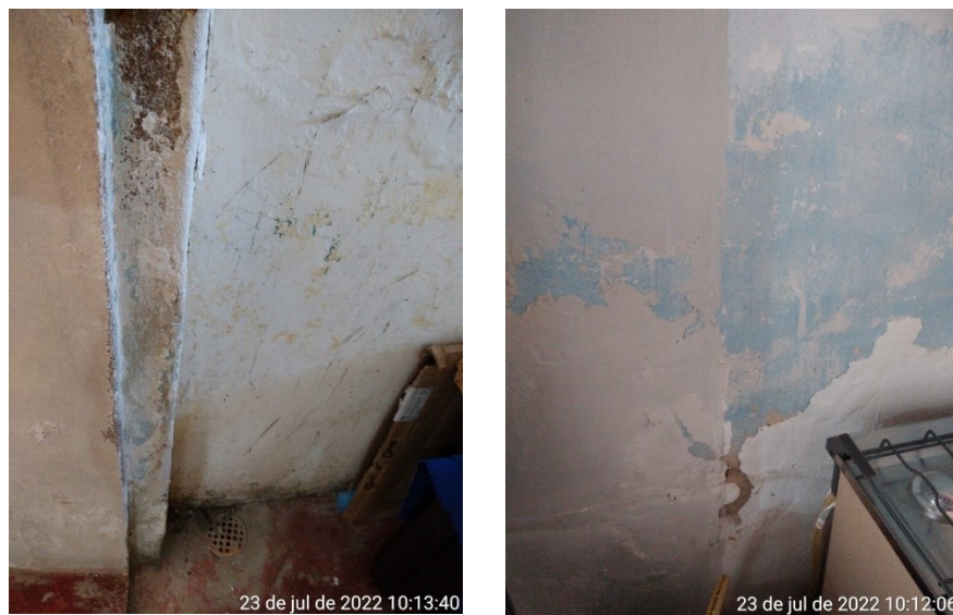
Figura 14- Descascamento e Deslocamento da Pintura
