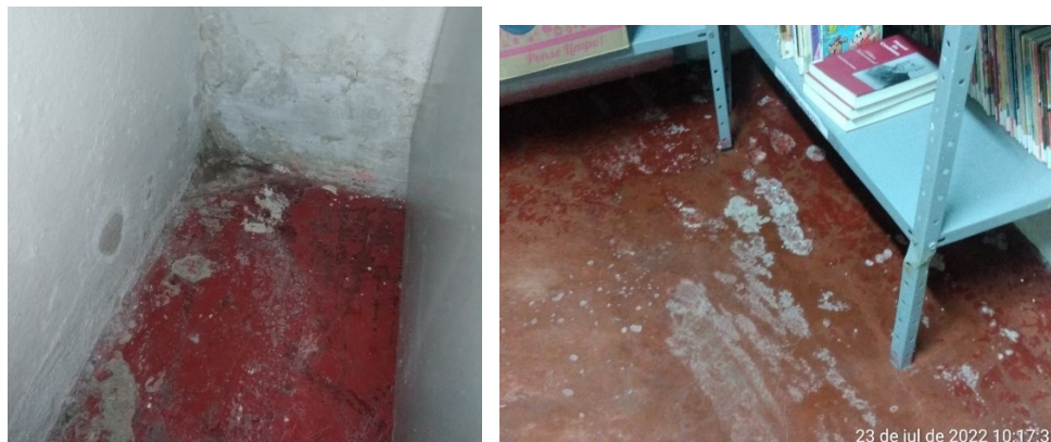
Figura 16 - Desgaste Superficial no Piso de Cimento Queimado
