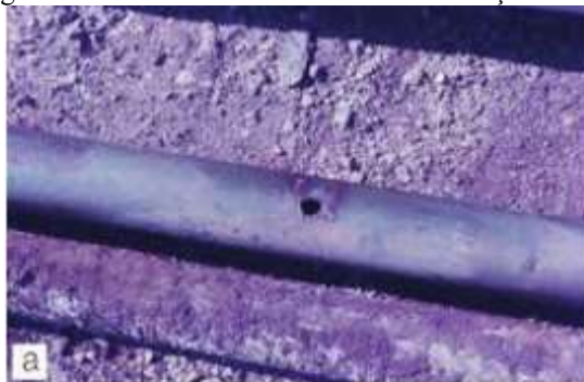
Figura 3: Corrosão eletrolítica em tubos de aço-carbono.
