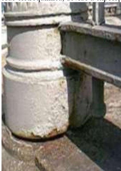
Figura 1: Corrosão eletroquímica, devido a exposição atmosférica.
