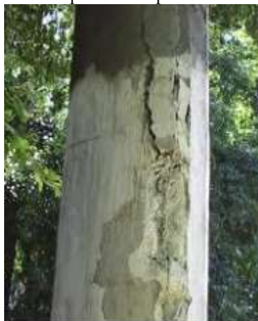
Figura 2: Corrosão química em poste de concreto armado.
