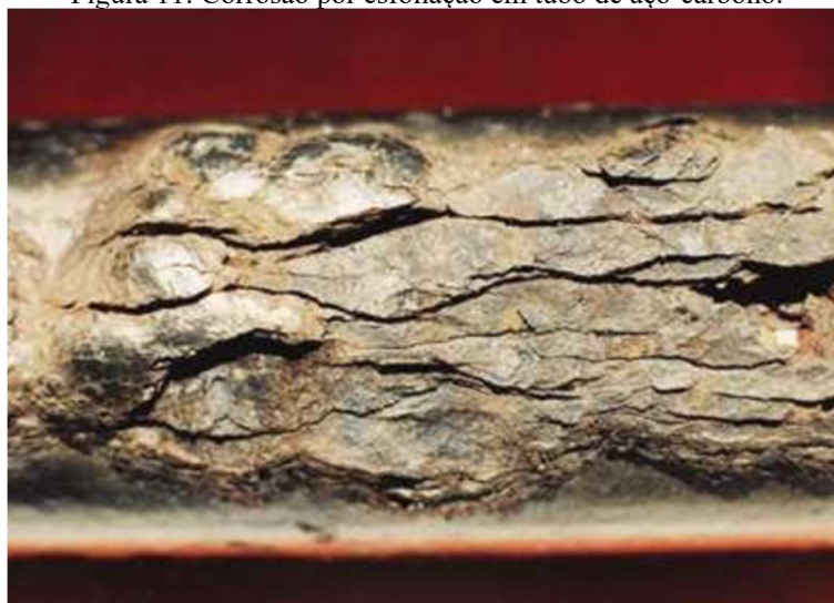
Figura 11: Corrosão por esfoliação em tubo de aço-carbono.
