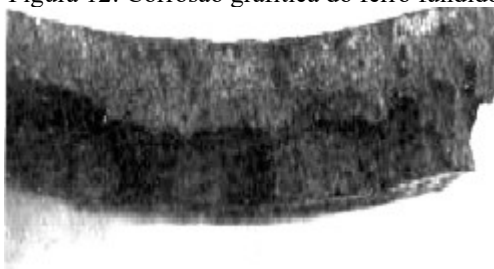
Figura 12: Corrosão gráfitica do ferro fundido.
