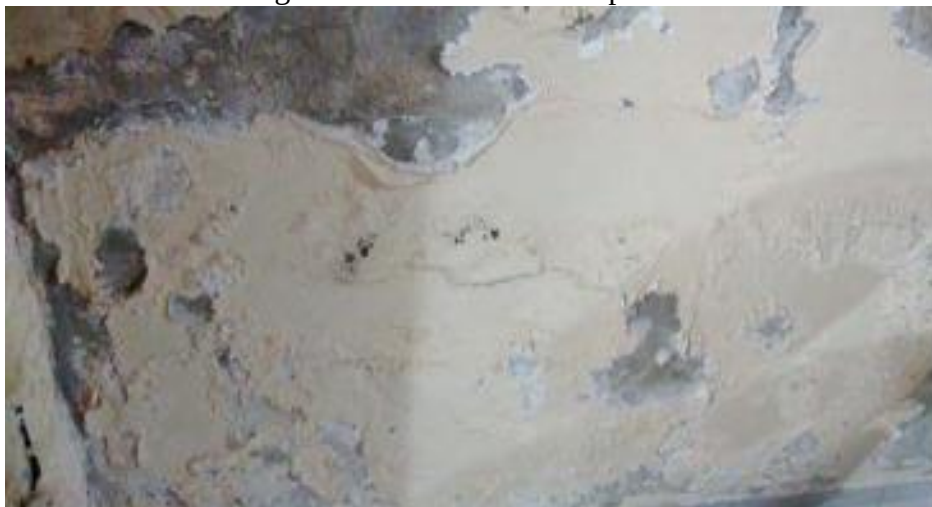
Figura 4 - Eflorescência em parede.
