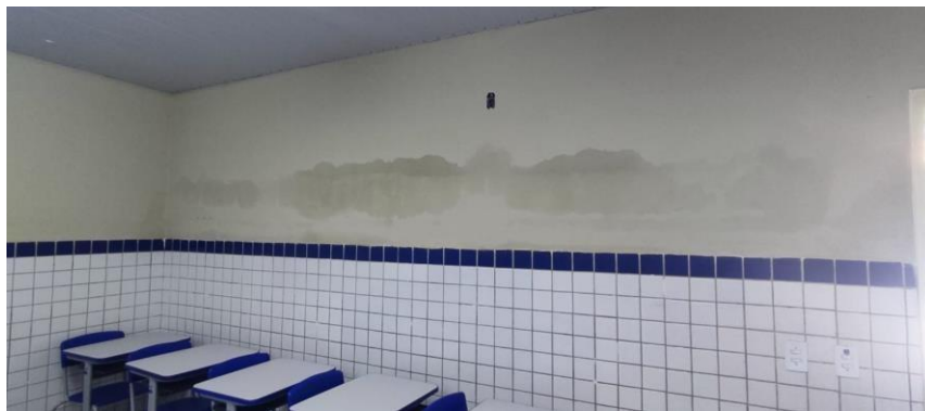
Figura 29 – Aparição de mancha em sala de aula devido infiltração.
