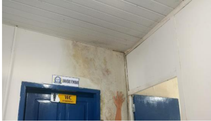
Figura 10 – Manchas causadas por infiltração de água em parede do banheiro.
