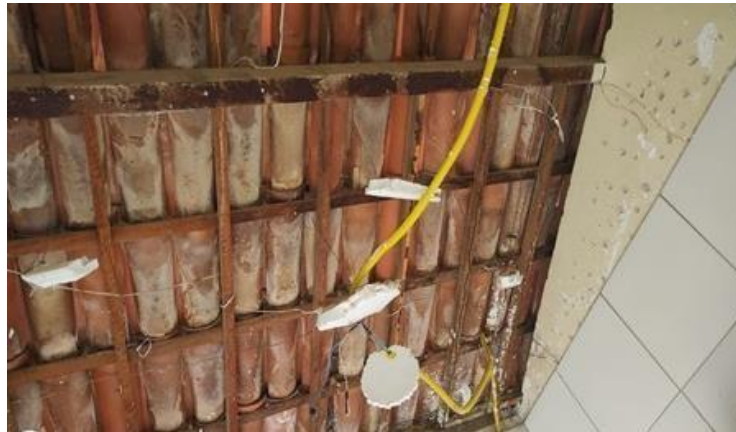
Figura 13 - Manchas no telhado devido infiltração.
