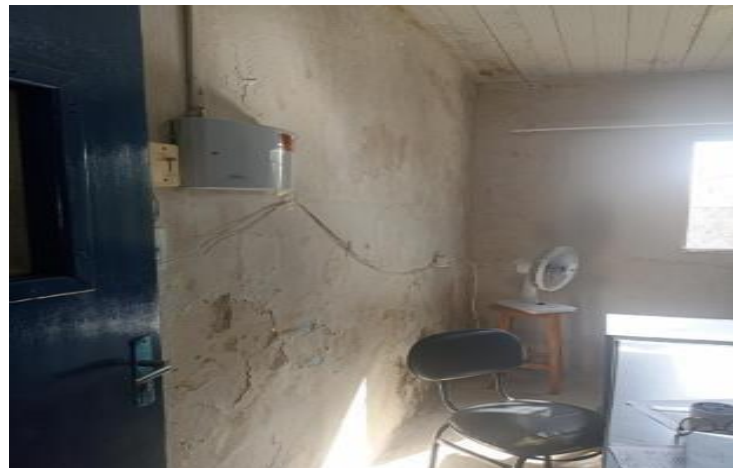
Figura 11 – Eflorescências em parede.
