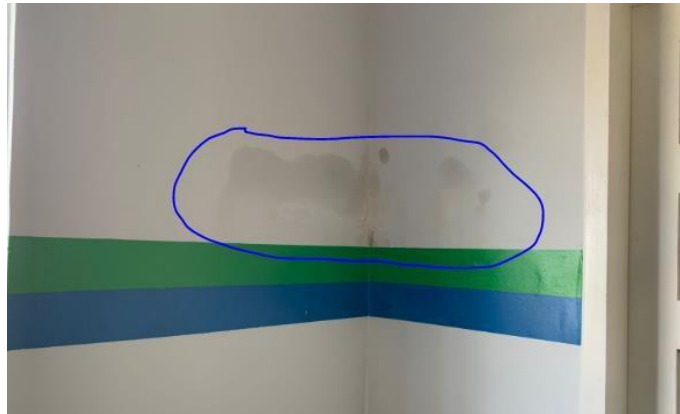
Figura 28 – Aparição de mancha devido infiltração.
