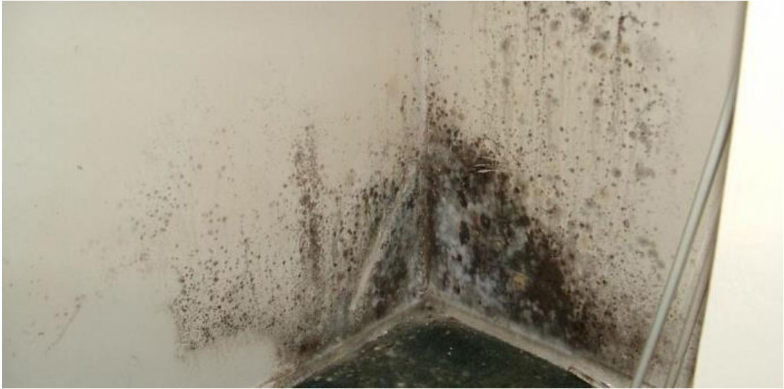
Figura 3 - Mofo e bolor em parede.
