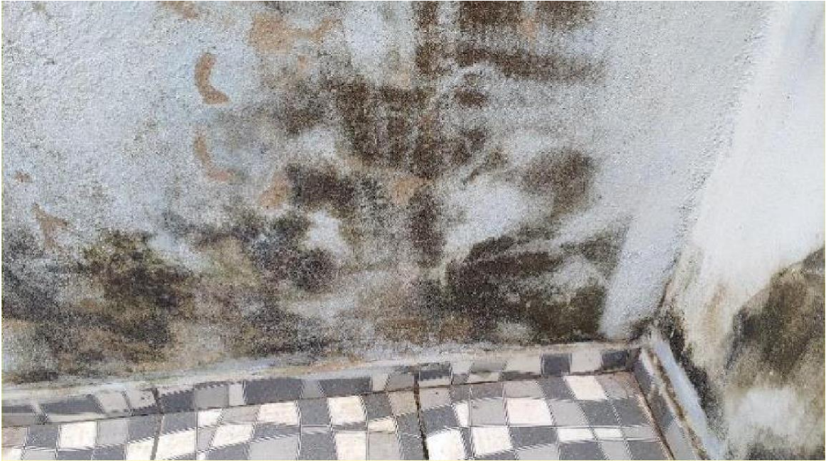
Figura 2 - Patologia de manchas em parede.
