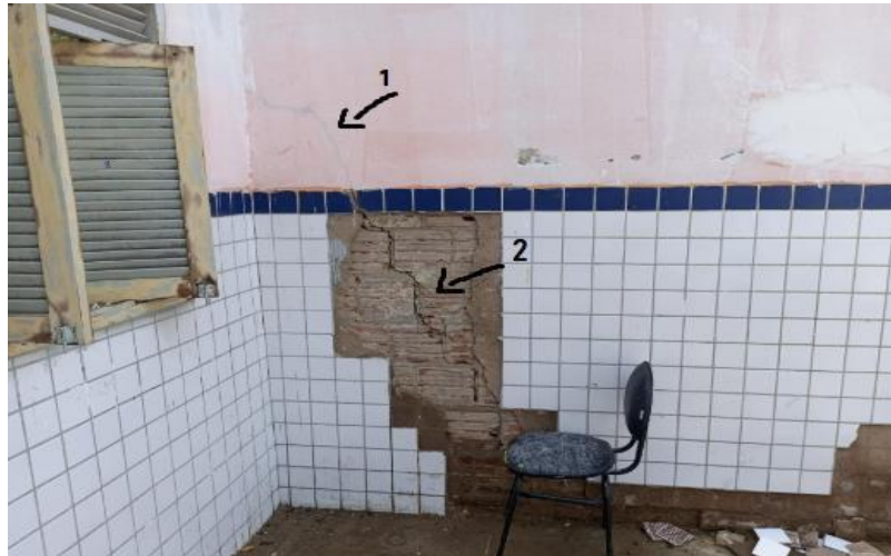
Figura 8 – Fissura e Trinca localizadas em uma das salas de aula.
