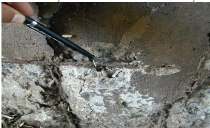
Figura 6 - Deterioração do concreto com armadura de aço exposta.
