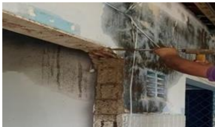
Figura 12 – Mofo na parede.
