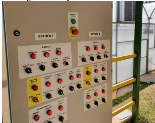
Figura 17 - Quadro de comando.
