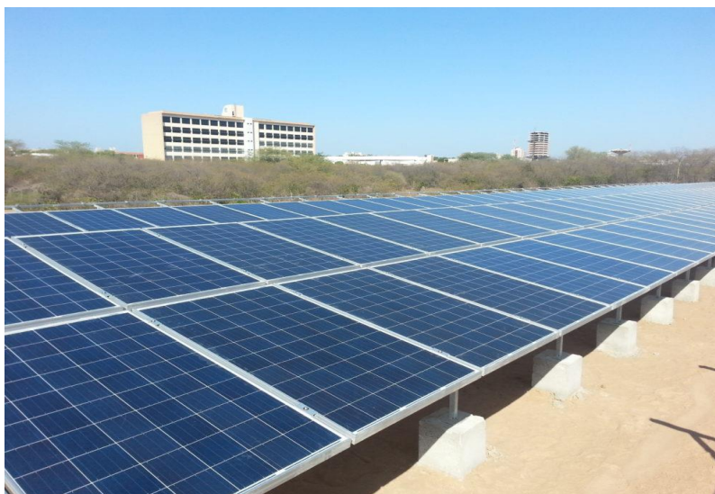
Figura 2 - Usina solar fotovoltaica da UFERSA (Autoria própria).
