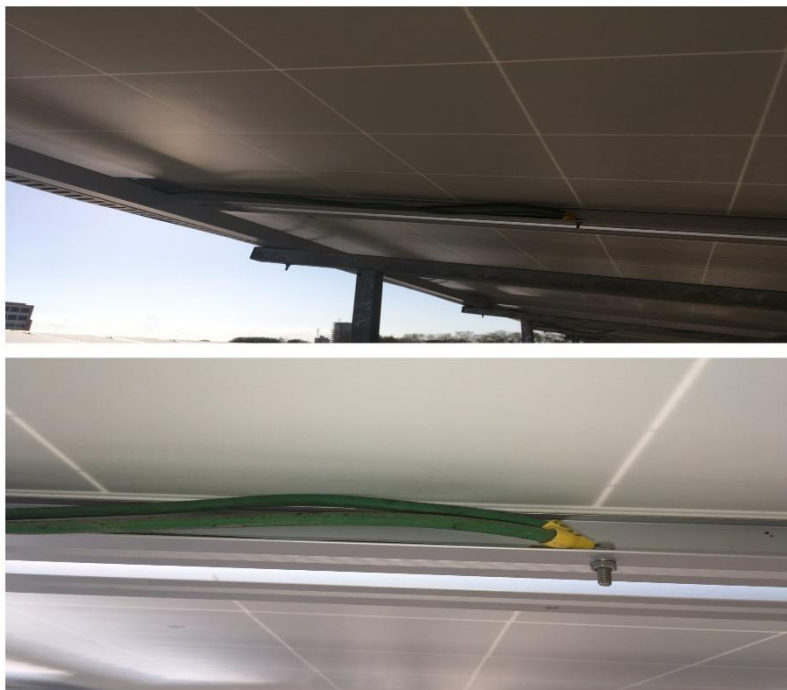
Figura 7- Detalhe da conexão do aterramento dos módulos fotovoltaicos (Autoria própria).
