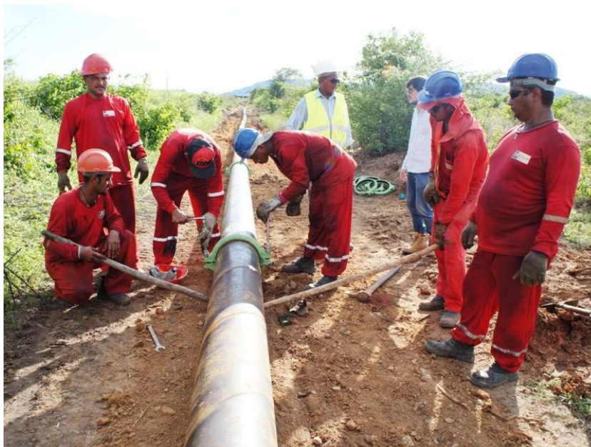
Figura 10: Adutora de engate rápido
