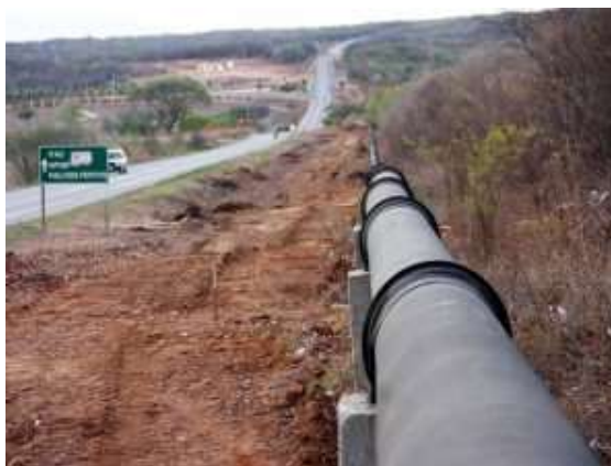
Figura 4: Adutora de engate rápido
