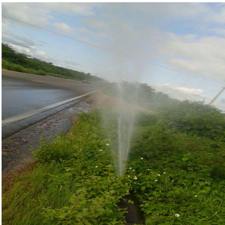
Figura 11: Adutora com vazamento
