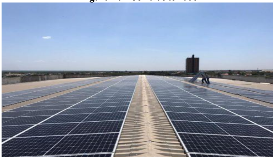
Figura 10 - Usina de telhado
