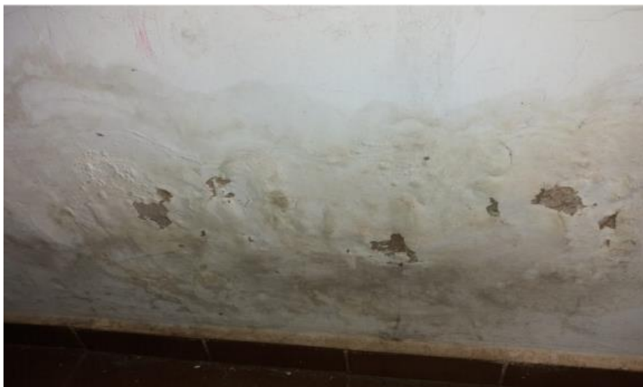
Figura 4- Umidade de infiltração em parede de um quarto domicílio unifamiliar
