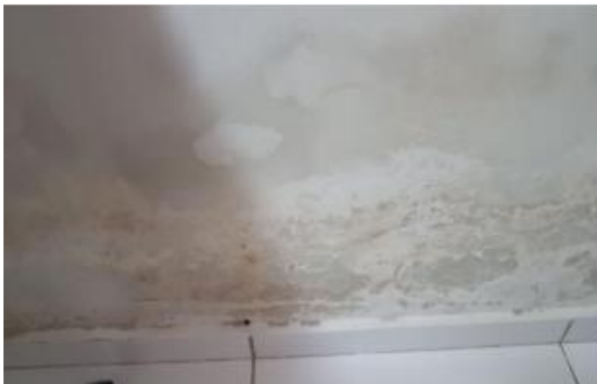
Figura 5- Aparecimento de eflorescência em parede de sala de uma residência
