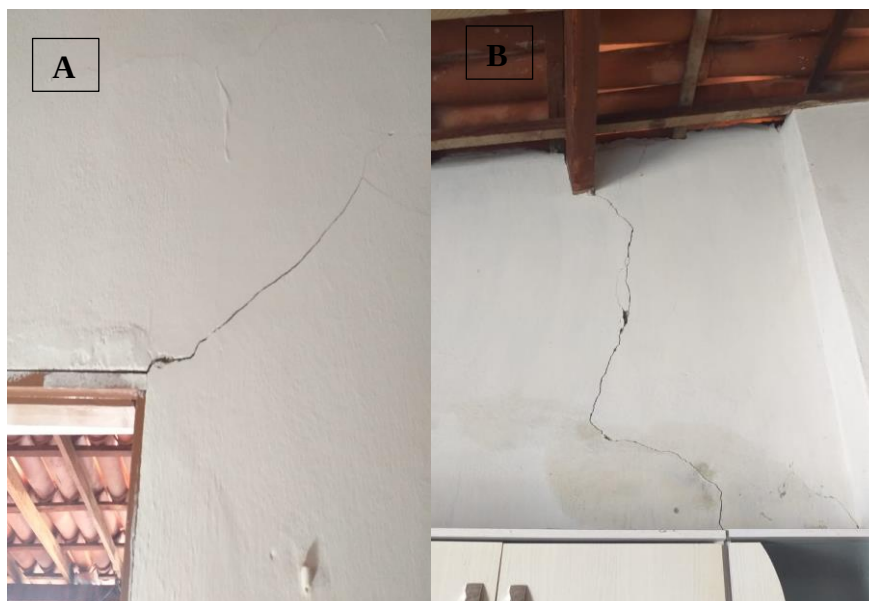
Figura 9- Incidência de fissuras em residências do bairro Francisco Nogueira. A) casa 07; B) casa 08.
