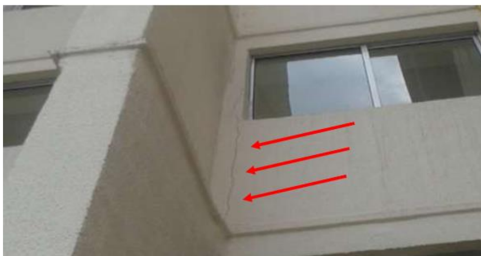
Figura 3- Fissura em parede externa
