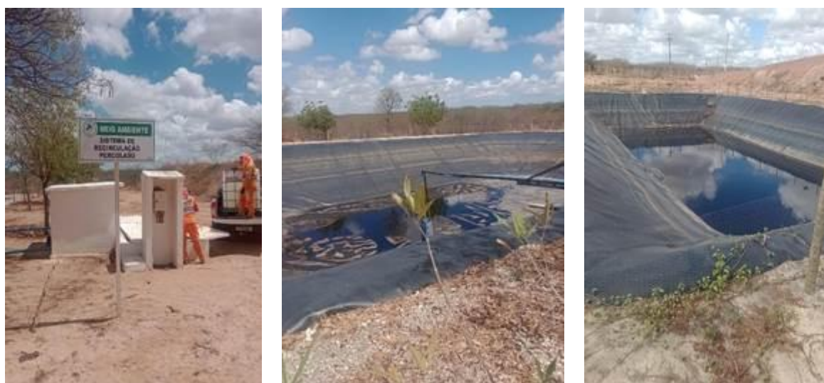
Figuras 4: Sistema de tanques de recirculação de lixiviado das células do aterro sanitário, Mossoró-RN. Fonte: O autor (2026).
