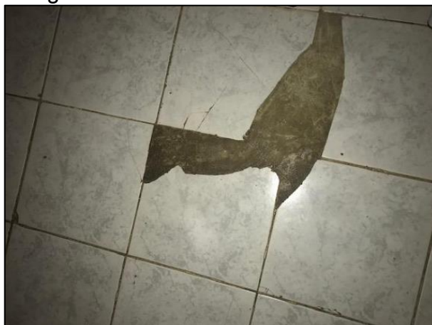
Figura 4 – Deslocamento de cerâmica
