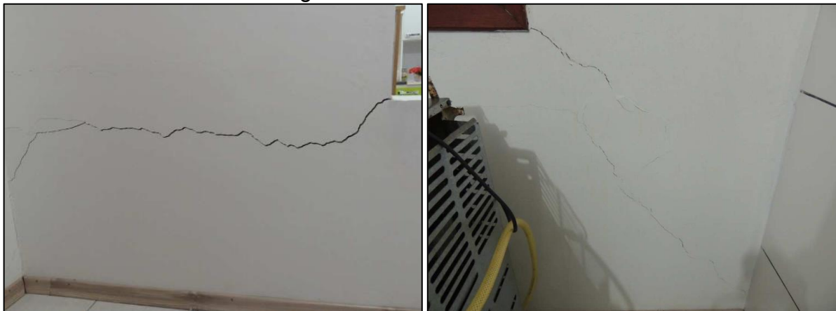
Figura 3 – Trincas e fissuras
