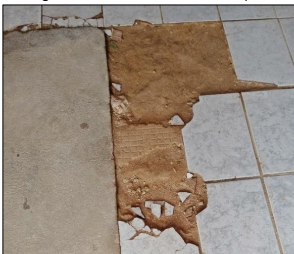
Figura 24 – Deslocamento de piso
