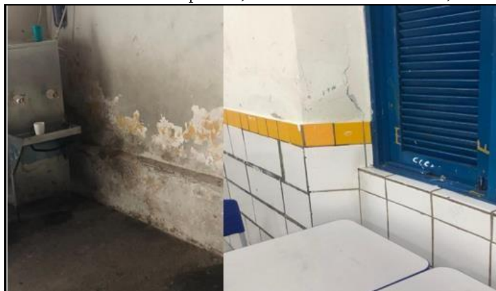
Figura 7 - Descascamento de pintura; trincas e fissuras na EEAC, Caraúbas-RN.
