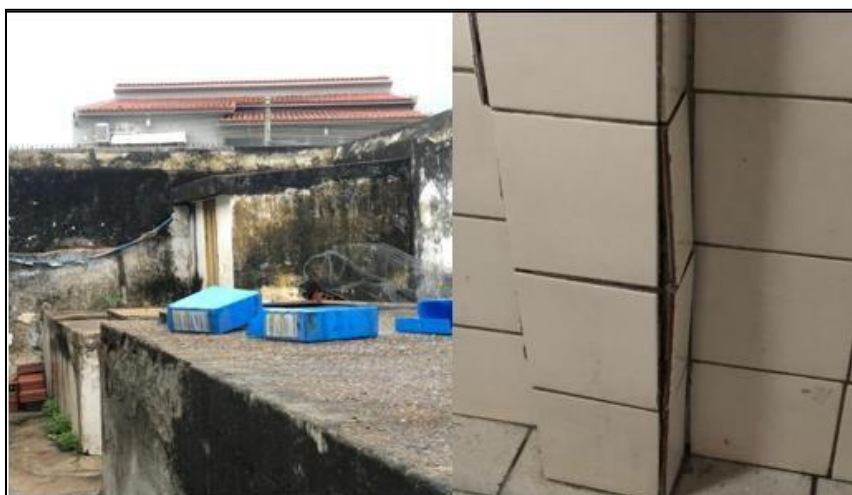
Figura 8 - Manchas de infiltração e bolor; Deslocamento cerâmico na EEAC, Caraúbas-RN.
