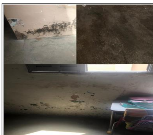
Figura 14 - Manchas de mofo; fissuras; deslocamento da tinta na Escola Gregório de Batistade Moraes, Caraúbas-RN.
