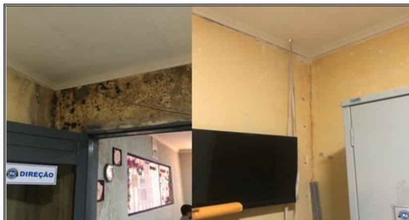
Figura 9 - Manchas e bolor; Fissuras e trincas na EESG, Caraúbas-RN
