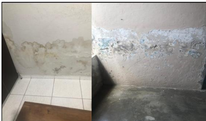
Figura 13 - Manchas de infiltração; descascamento de pintura na Escola Gregório de Batistade Moraes, Caraúbas-RN.
