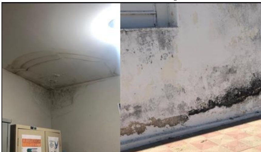
Figura 10 - Manchas de infiltração; deslocamento de pintura na Escola Estadual Sebastião Gurgel, Caraúbas-RN
