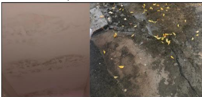
Figura 11 - Manchas de infiltração; Fissuras e trincas na EEPLGO, Caraúbas-RN.
