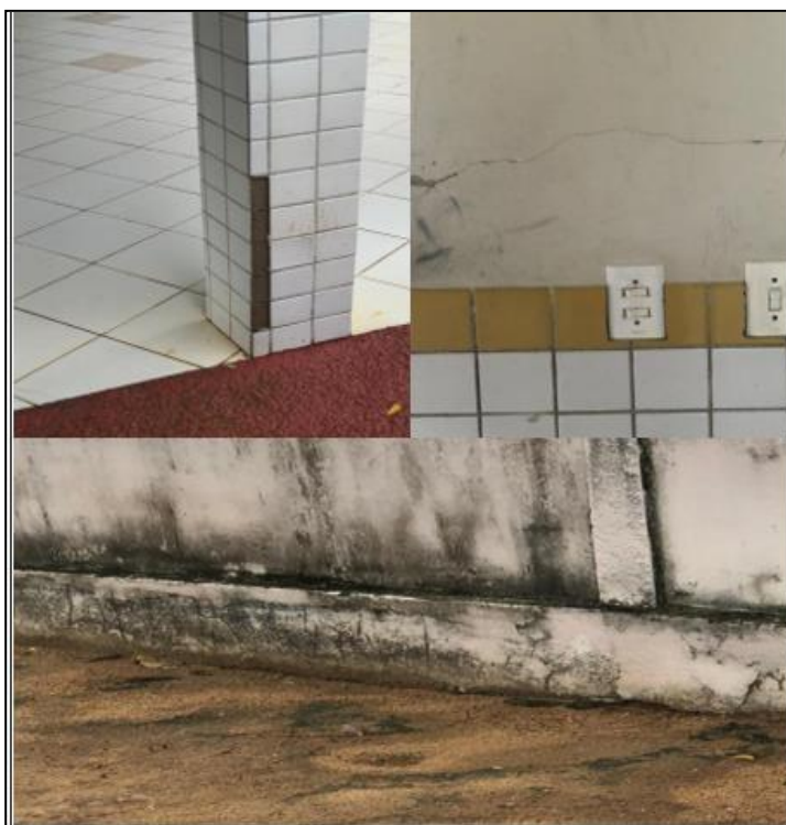
Figura 6 - Deslocamento em revestimento cerâmico; fissuras na parede; Manchas de infiltração na EMLGFA, Caraúbas -RN.
