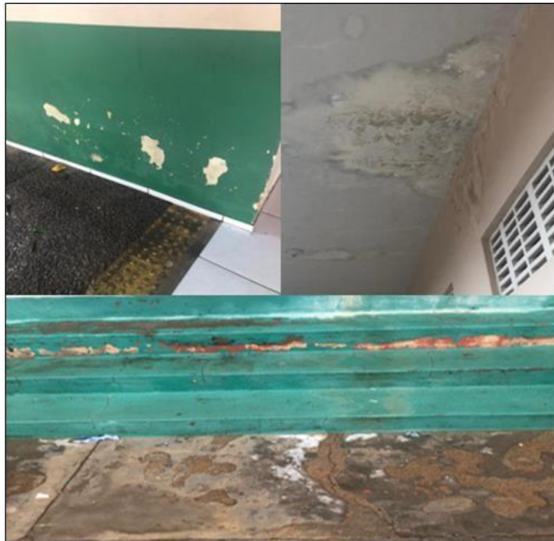
Figura 5 - Desplacamento de pintura em parede; manchas de infiltração; fissuras e trincas em escada e piso na EMJO, Caraúbas-RN.
