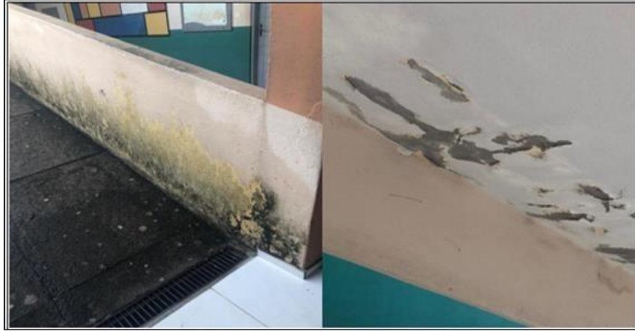
Figura 4 – Manchas de infiltrações com acúmulo de lodo e Desplacamento de pintura erevestimento argamassado no teto EMJO – Caraúbas-RN.
