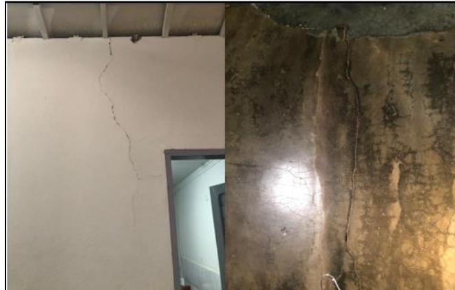
Figura 15 - Fissuras em parede e piso na Escola Francisco de Paula, zona rural do município de Caraúbas -RN.
