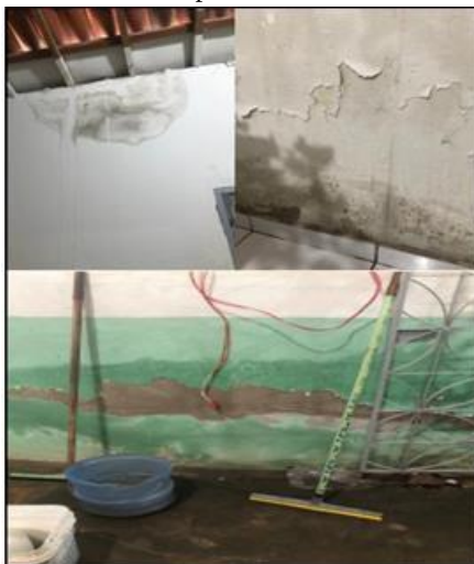
Figura 16 - Manchas de mofo, descascamento e deslocamento de pintura na Escola Francisco de Paula, zona rural do município de Caraúbas -RN.
