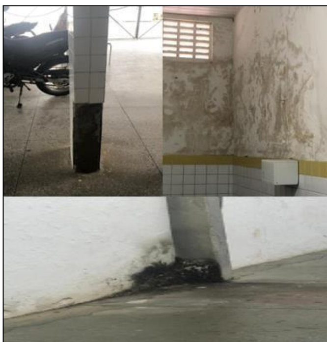
Figura 12 - Deslocamento cerâmico; Descascamento de pintura; Bolor na EEPLGO, Caraúbas-RN.
