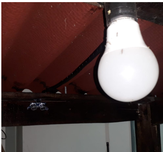
Figura 19 -Sensor ultrassônico posicionado no abrigo
