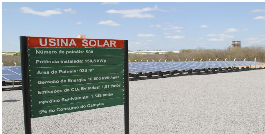
Figura 10 – Usinar Solar Fotovoltaico da UFERSA.
