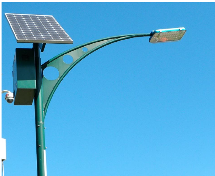
Figura 08 – Iluminação pública por sistema fotovoltaico.
