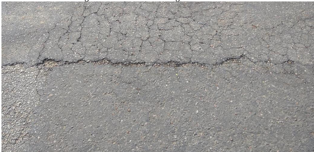
Figura 15: Trinca isolada longitudinal.
