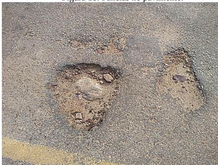
Figura 18: Panelas no pavimento.
