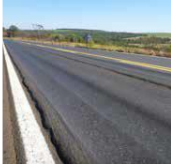
Figura 6: Afundamento formando um trilha de roda.
