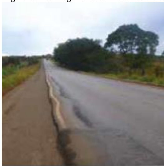
Figura 8: Escorregamento da massa asfáltica
