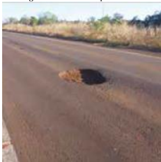
Figura 11: Buraco no pavimento
