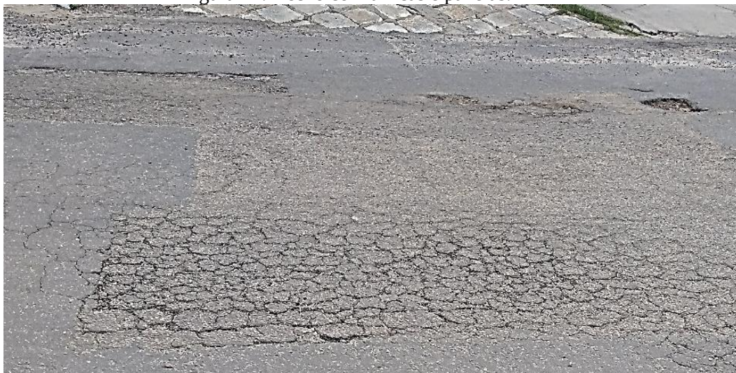
Figura 14: Trecho com trincas e panelas.
