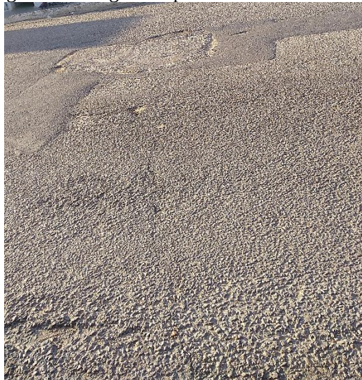
Figura 17: Desgaste superficial com remendos.
