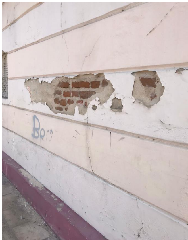
Figura 6 Manifestação Patológica encontrada no piso e na parede da fachada do Edifício em estudo.
