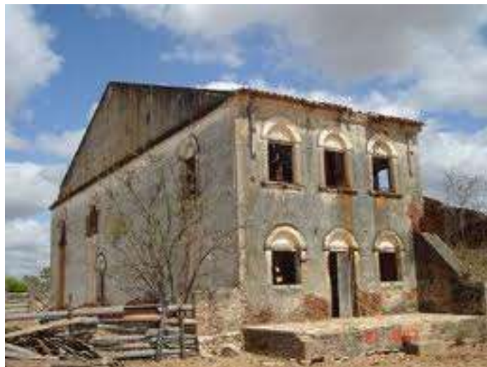
Figura 2 - Casarão começando a se deteriorar após ser abandonado.
