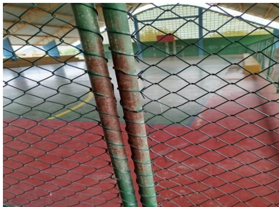
Figura 9 – Corrosão avançada nas bases metálicas do portão da quadra da Vila Caiçara (Paraná-RN).
