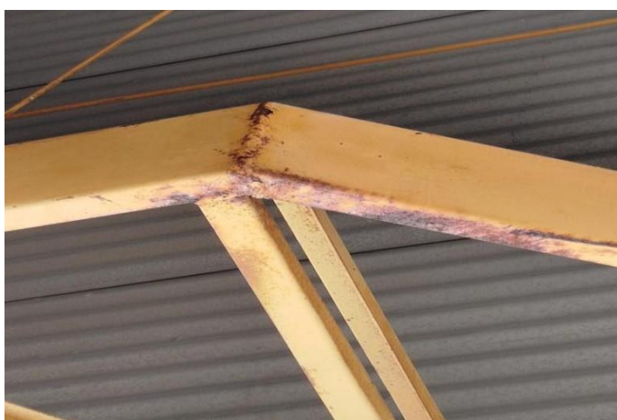
Figura 8 – Corrosão localizada em treliça metálica do telhado da quadra da Vila Caiçara.
