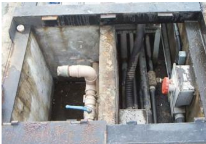
Figura 1 - Exemplo de corrosão eletroquímica
