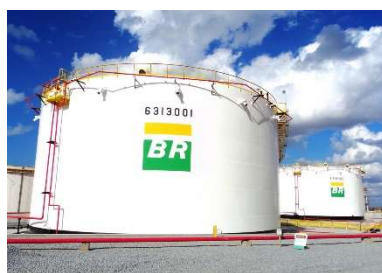
Figura 1 – tanque atmosférico vertical para armazenamento de petróleo e seus derivados (4).
