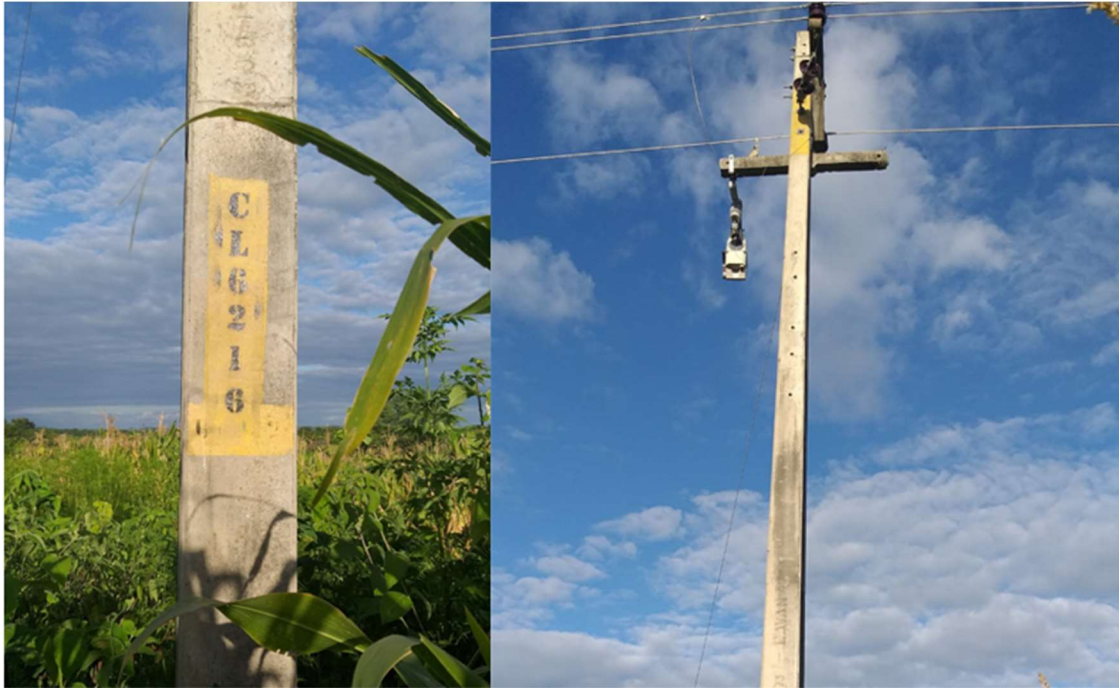
Figura 14 - Religador monofásico TripSaver RCL6216 instalado em campo
