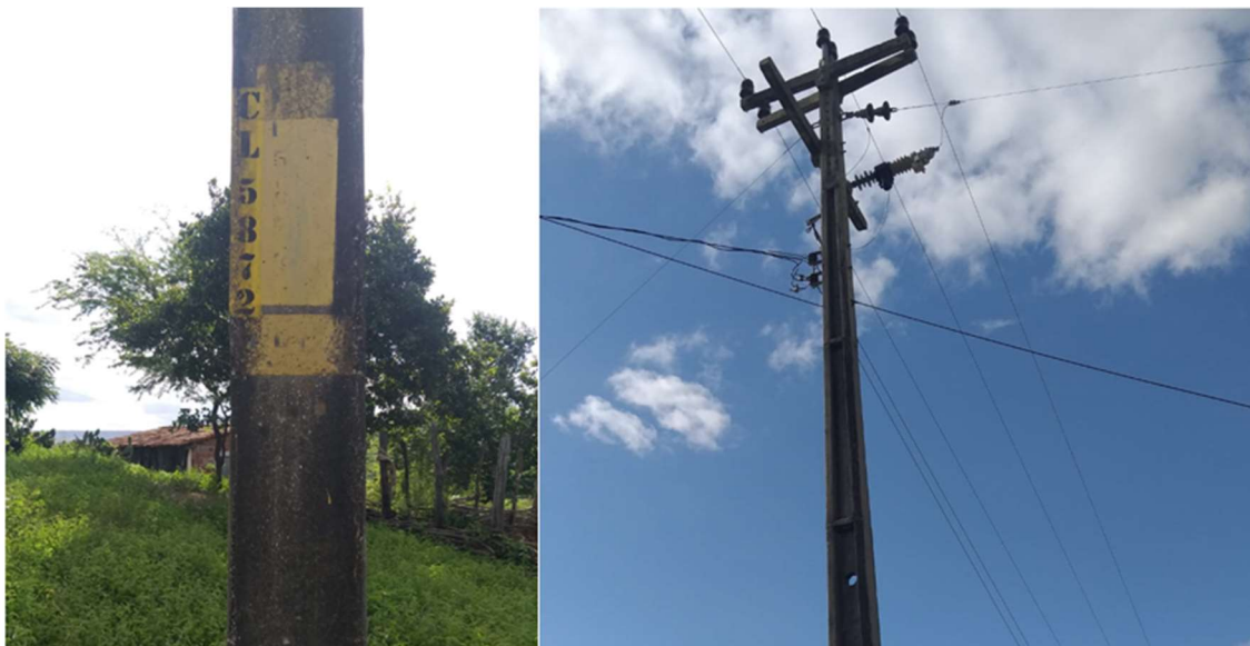
Figura 13 -Religador monofásico Fusesaver ICL5872 instalado em campo
