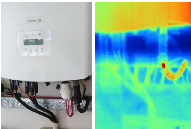
Figura 11: Cabos e conexões CC e CA.
