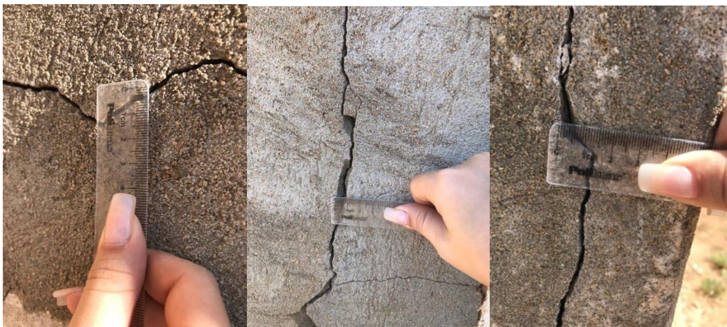
Figura 24 - Abertura de fissuras
