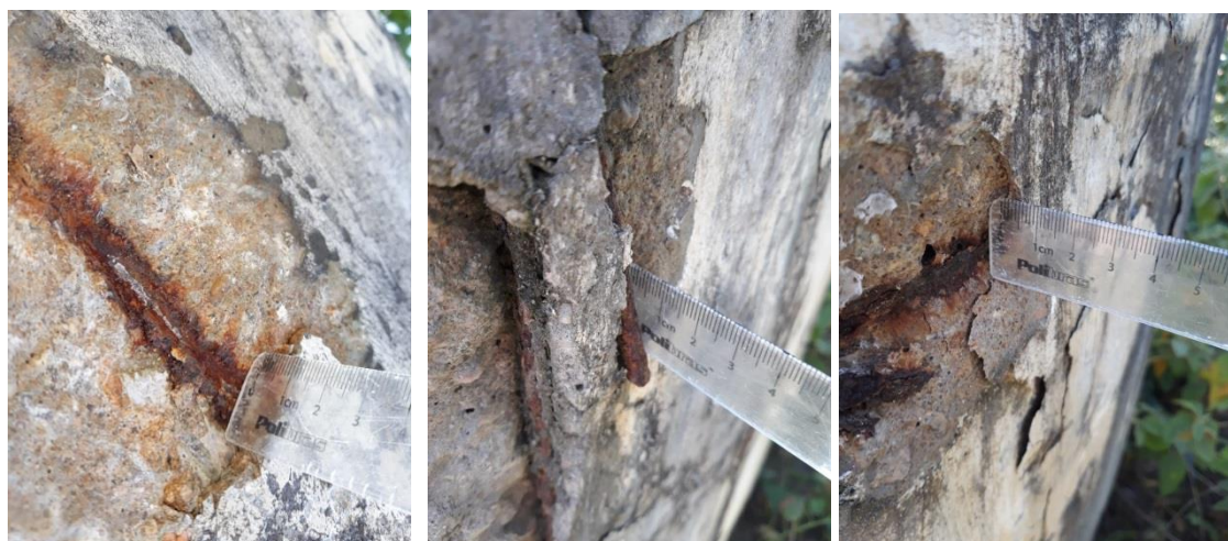
Figura 15 - Desplacimento no reservatório
