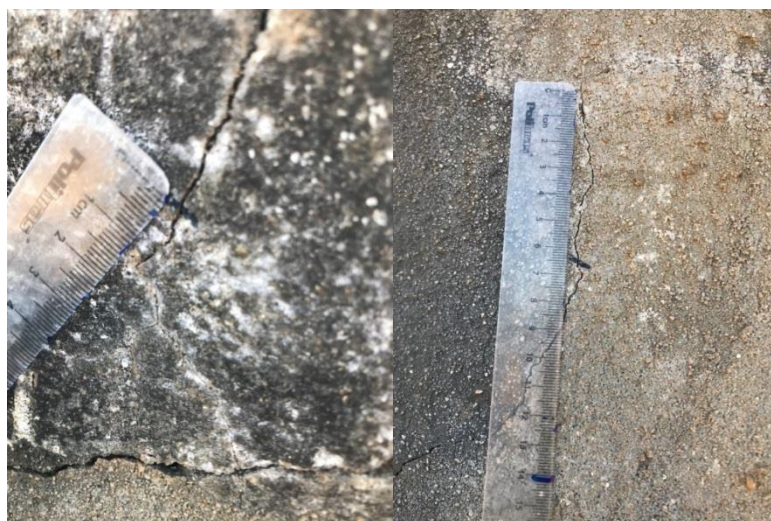
Figura 30 - Evolução no comprimento das fissuras
