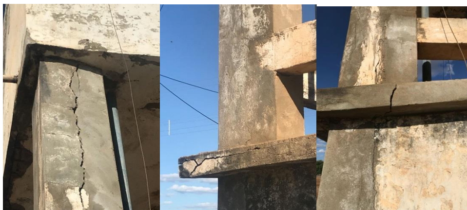
Figura 18 - Fissuras e trincas
