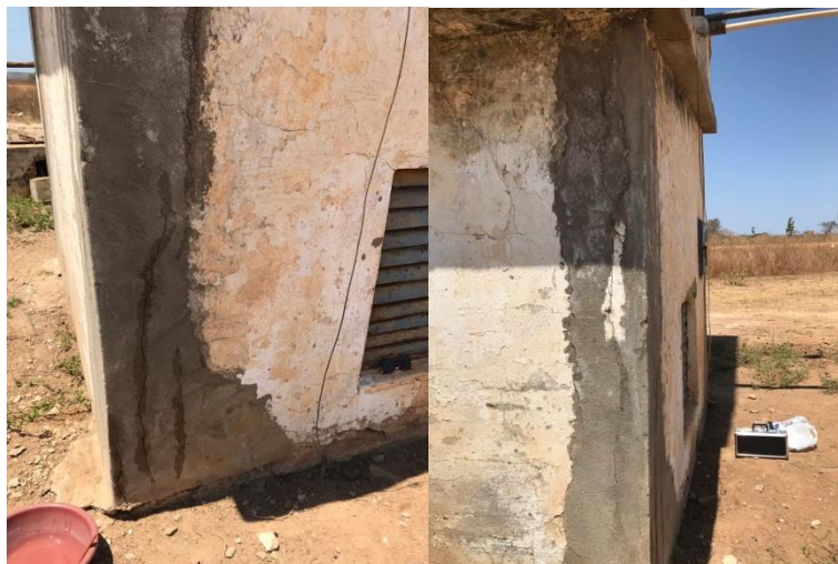
Figura 22 - Mapeamento das fissuras
