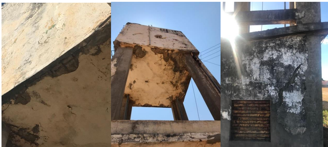
Figura 17 - Corrosão no reservatório
