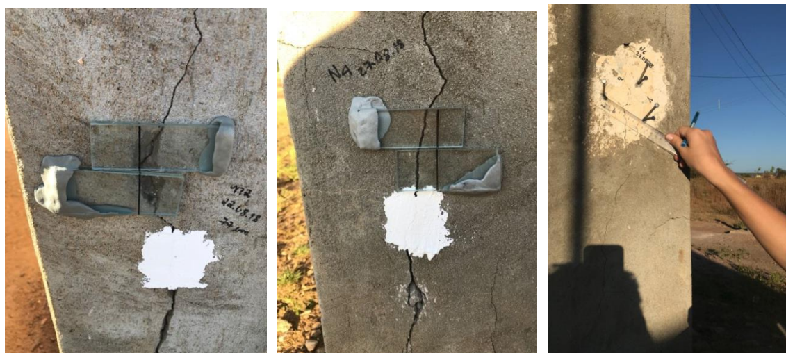
Figura 28 - Controle de fissuras
