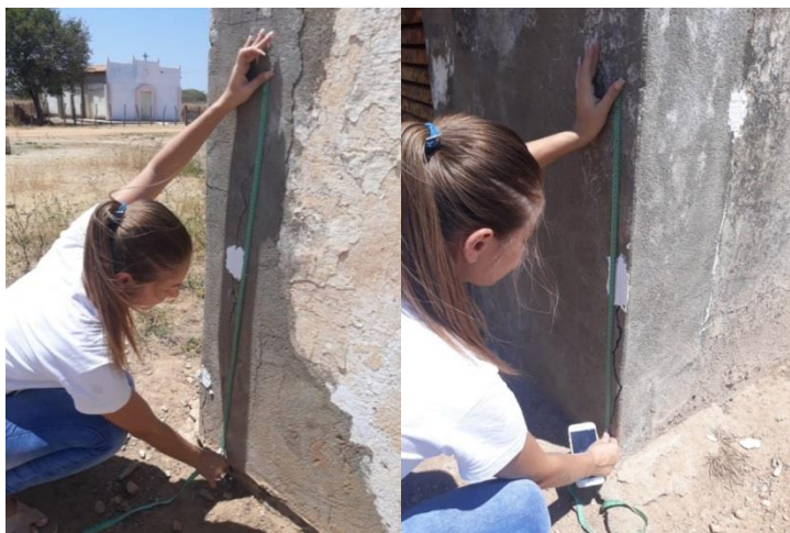
Figura 26 - Comprimento das fissuras
