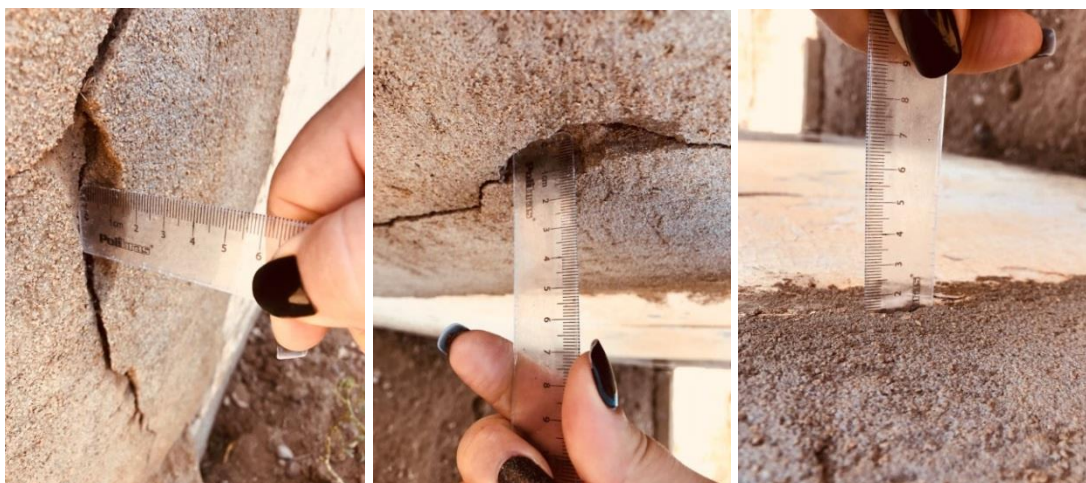
Figura 25 - Profundidade das fissuras
