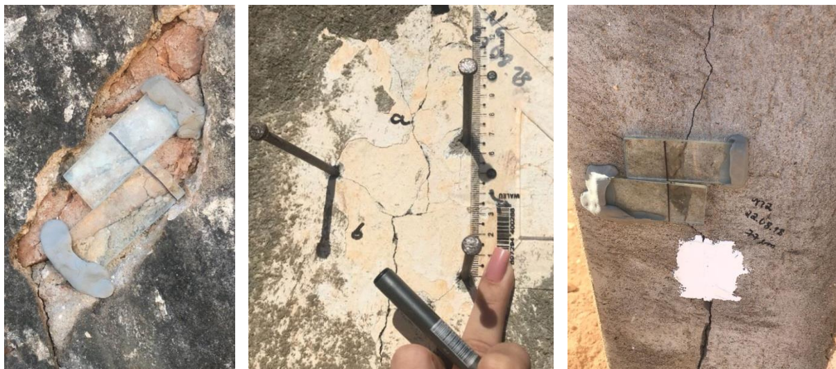
Figura 29 - Resultados do monitoramento de fissuras
