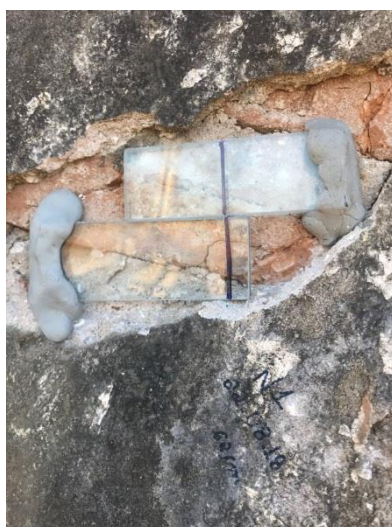
Figura 27 - Controle de fissura na janela de inspeção n1.
