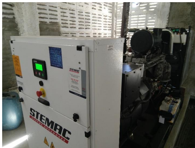
Fig. 6. Gerador instalado no hospital. Fonte: Autoria própria, 2020.
