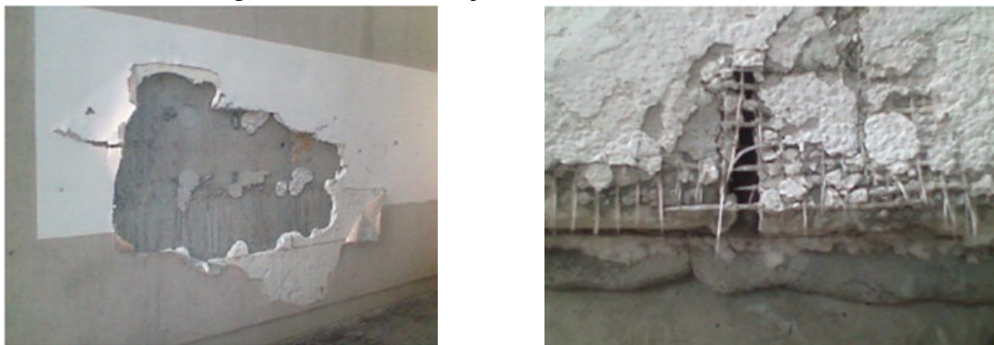
Figura 14 – Danificações em sistemas ETICS.
