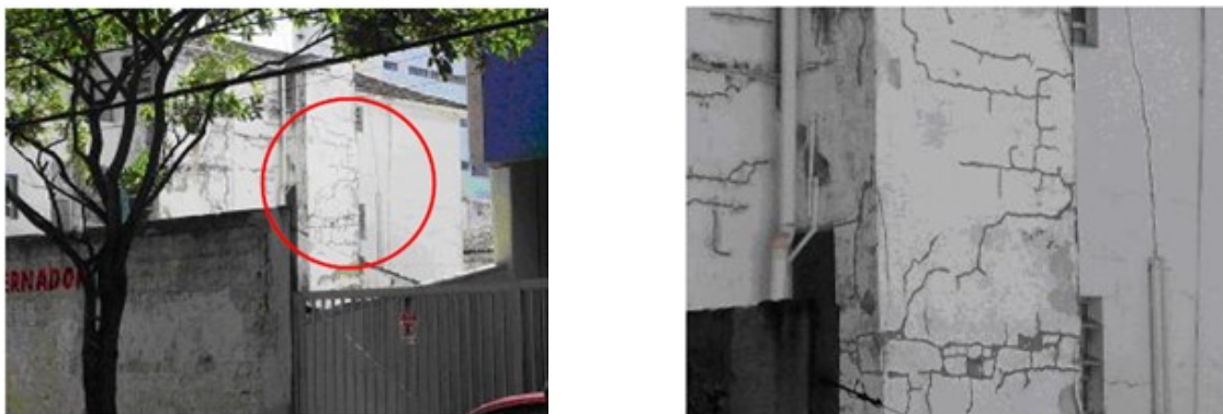
Figura 5 –Fissuras devido a retração em argamassa de revestimento.
