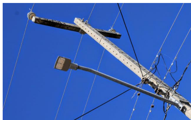
FIGURA 3. LUMINÁRIA SUBSTITUÍDA NA ZONA RURAL DE MOSSORÓ.
