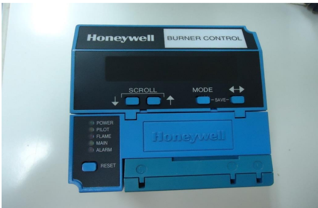
Figura 10 – Controlador do queimador
