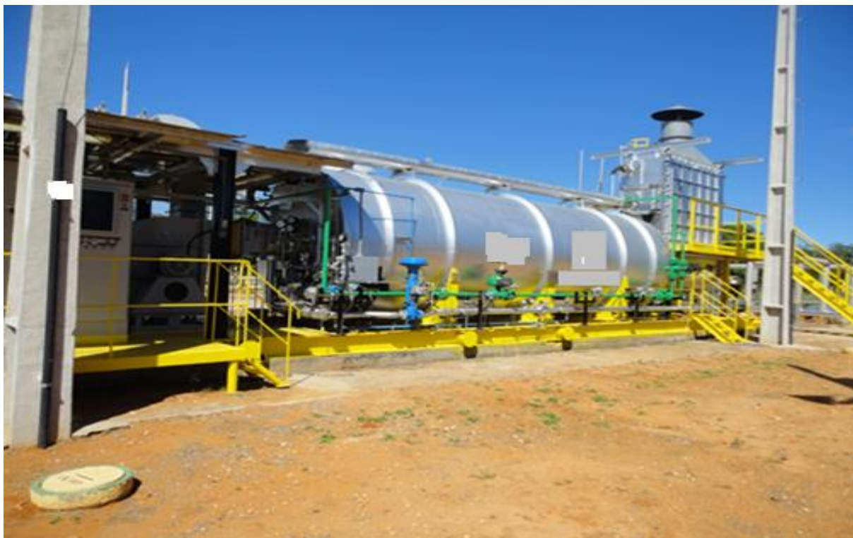
Figura 01 – Gerador de vapor.
