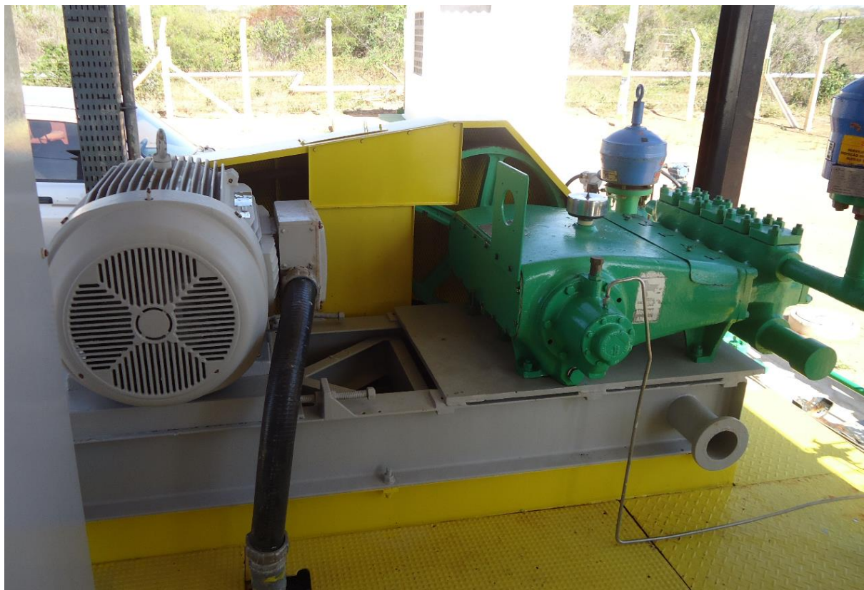
Figura 22 – Conjunto motor elétrico e bomba d'água
