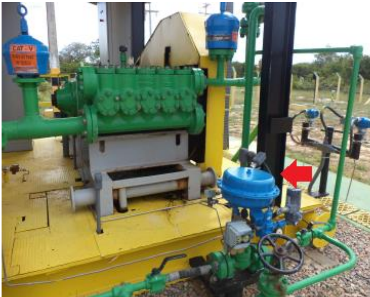
Figura 23 – Válvula de recirculação PV – 004.
